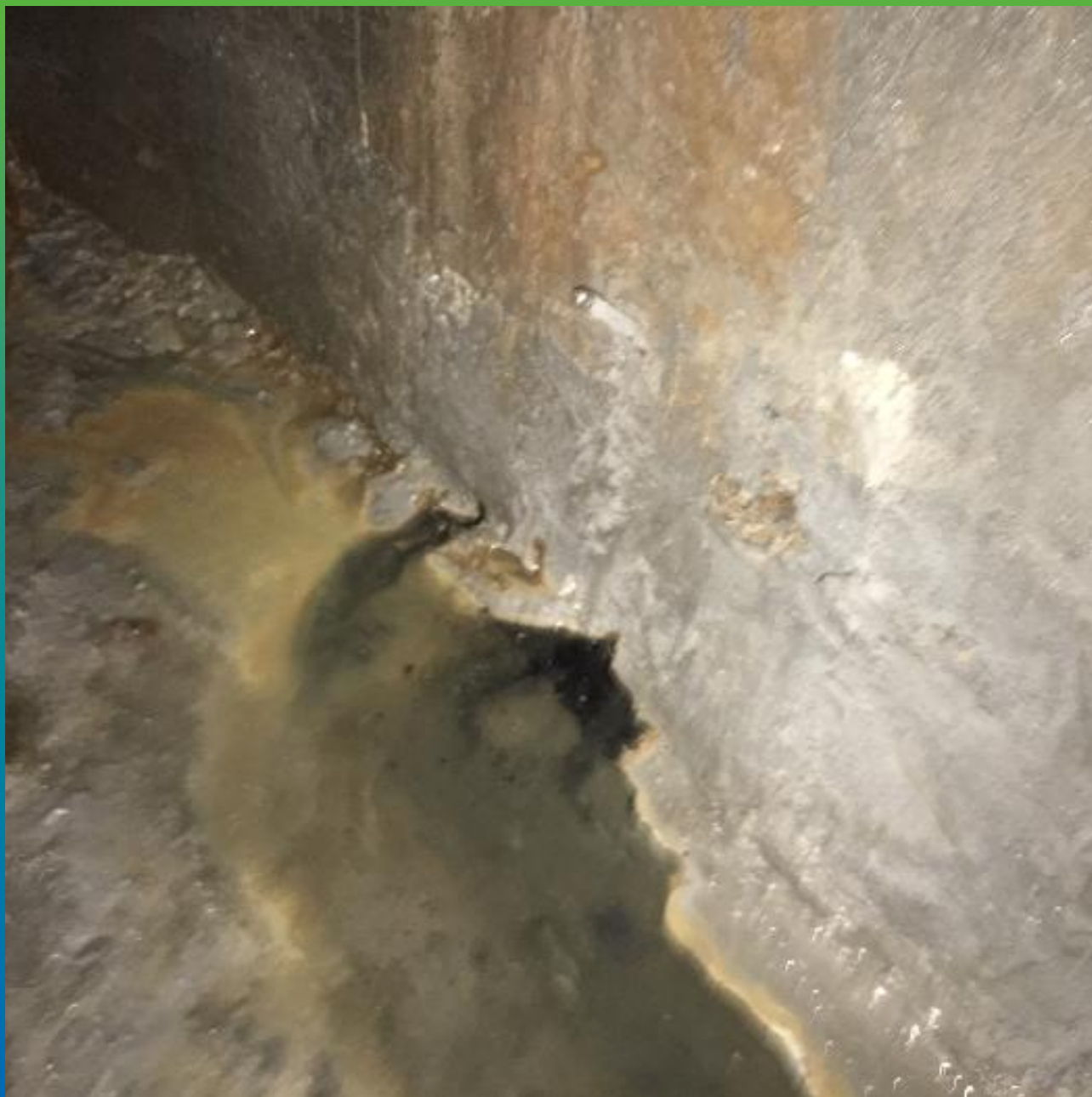
Вид протечек в коллекторе
