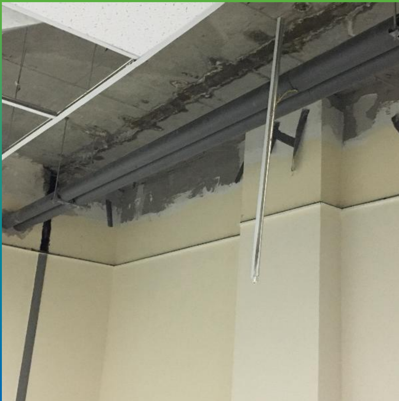
Протечка деформационного шва
