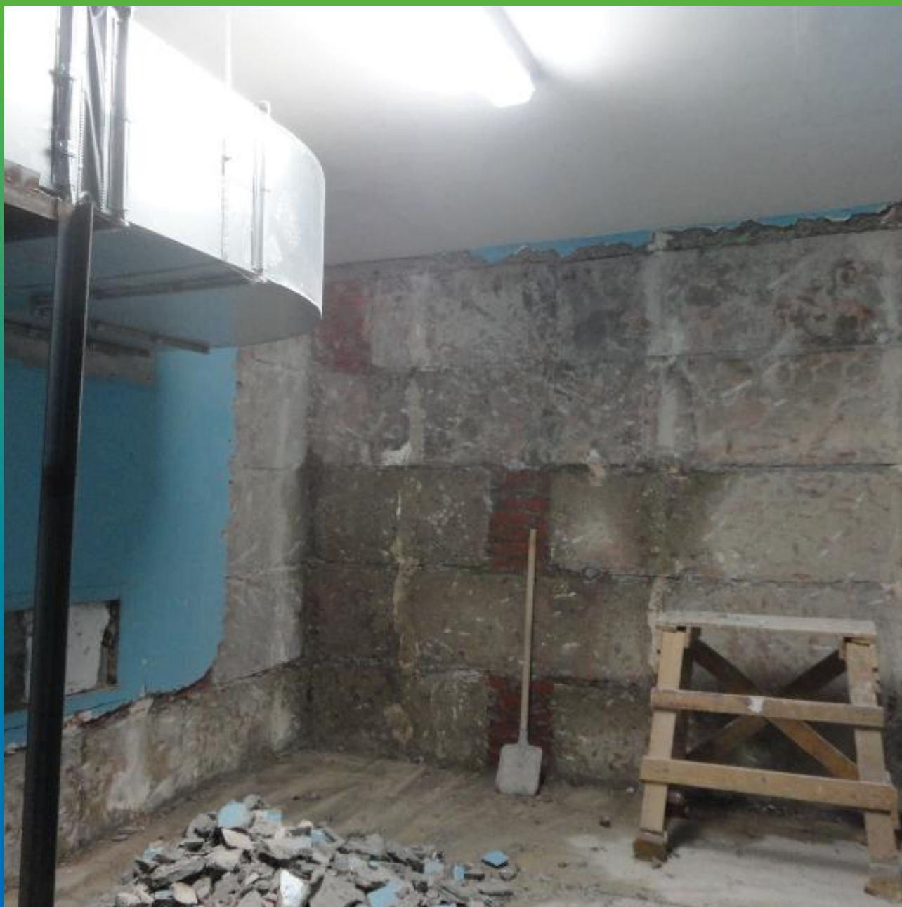
Проблемные места между блоками.
