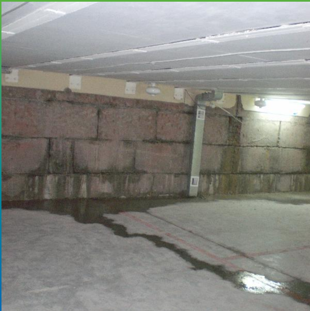
Проблемные места в швах между блоками.
