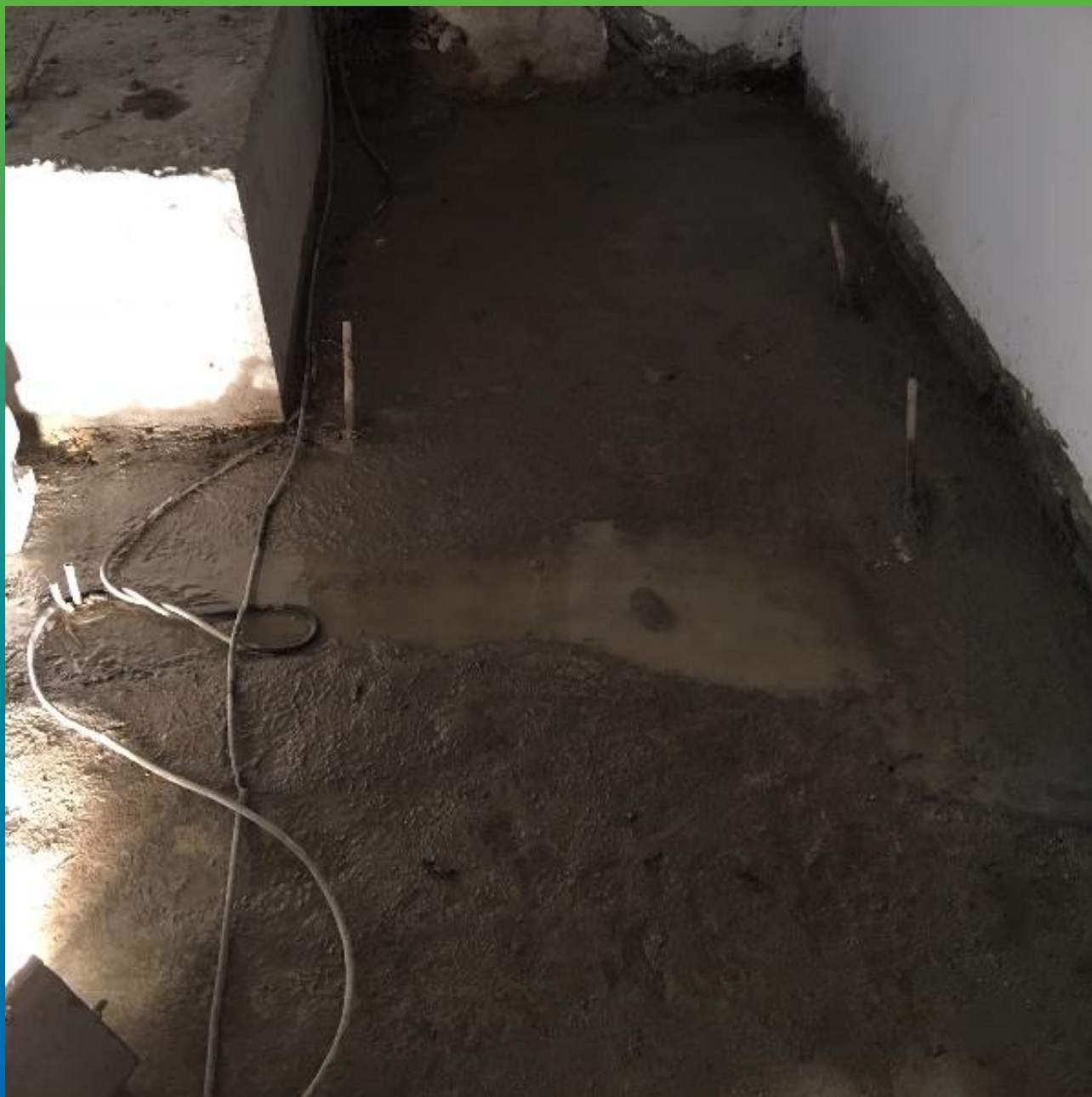
Протечки по фундаментной плите
