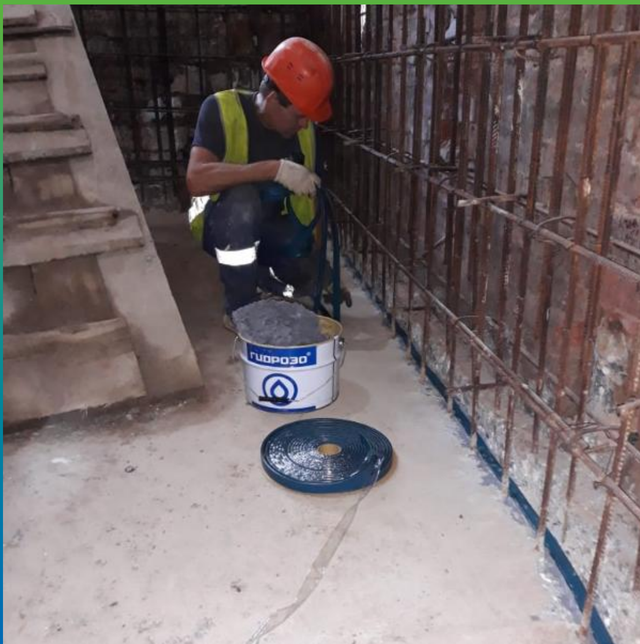
Монтаж гидрофильного шнура Манодил Свелл ХК 2507 на герметик Манодил Свелл 1К в холодный шов бетонирования
