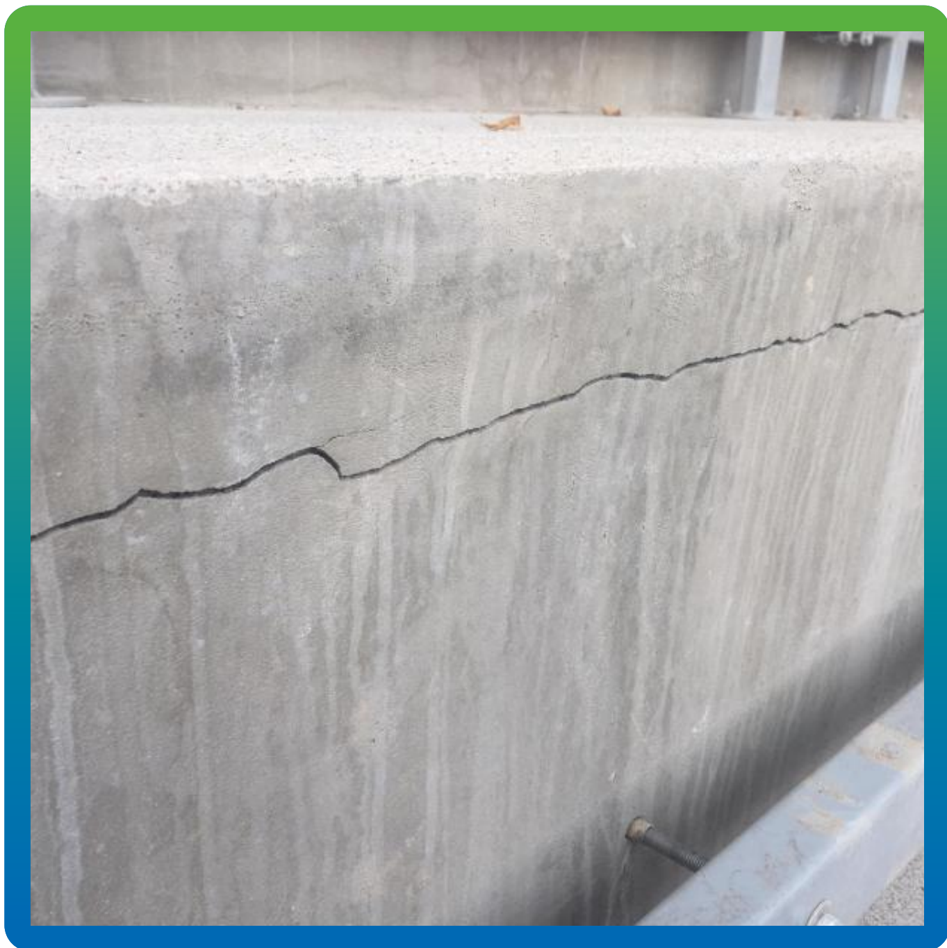
Трещина в основание трибуны
