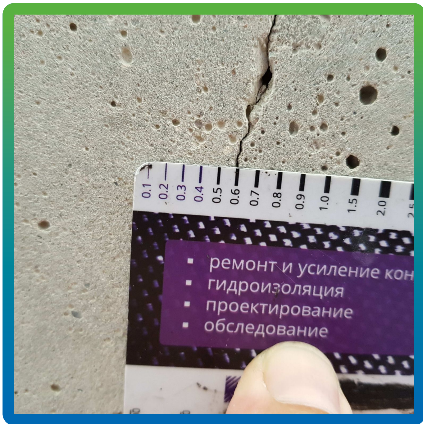
Замер раскрытия трещины
