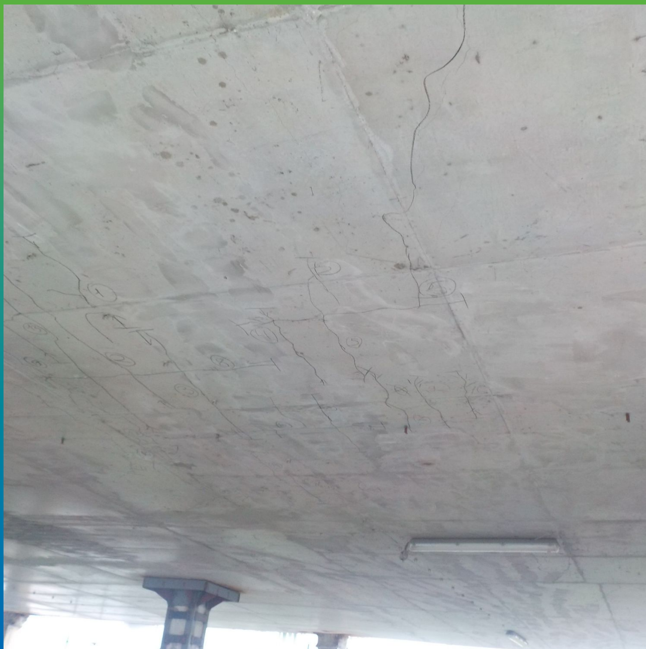
Трещины в плите перекрытия
