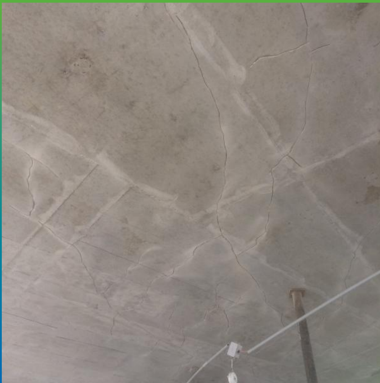
Трещины в плите перекрытия
