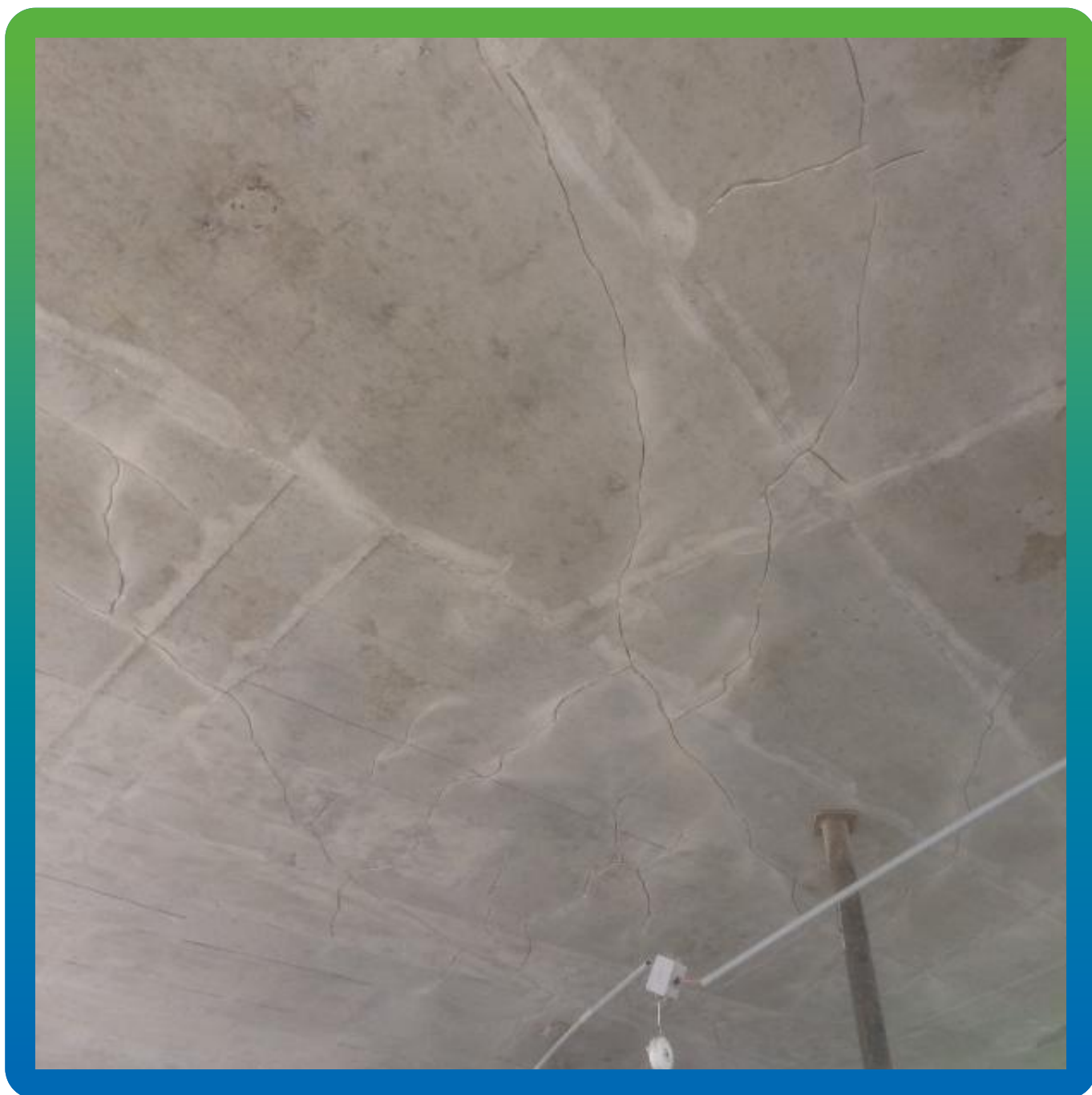
Трещины в плите перекрытия
