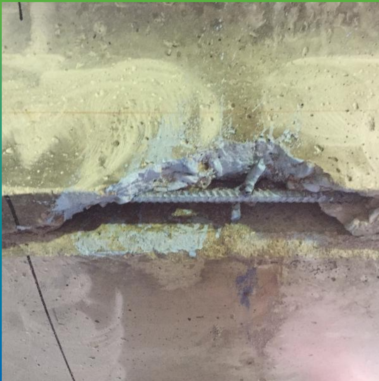
Локальный дефект с обнажённой арматурой
