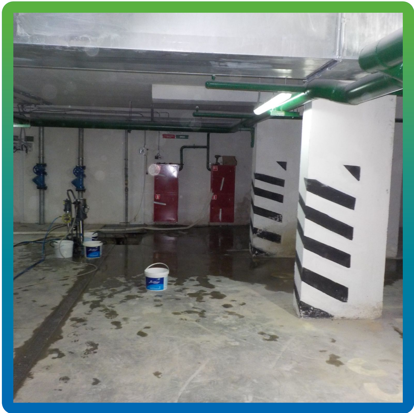
Двухкомпонентный насос на объекте
