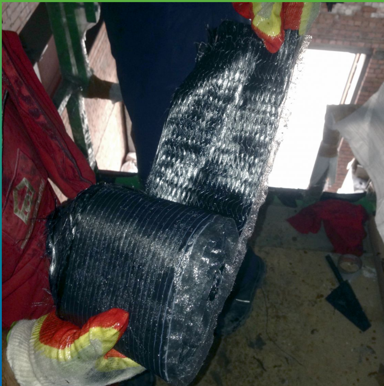
Подготовленный лост Армошел
