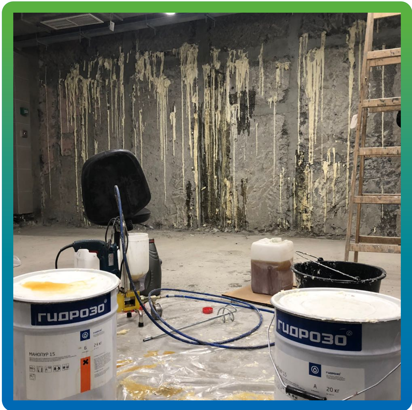
Трещины и плохо провибрированные места после проведения двухстадийного инъектирования
