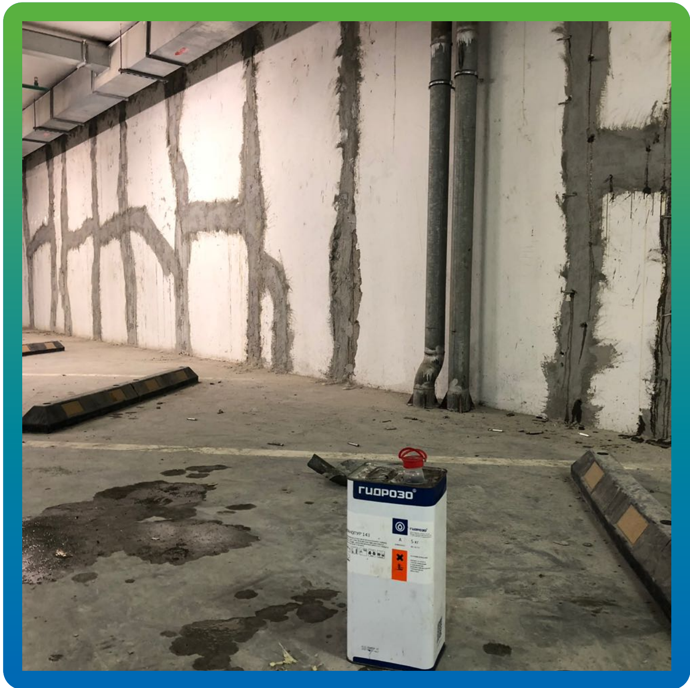
Трещины, расшities и зачеканенные составом Стармекс РМ 3
