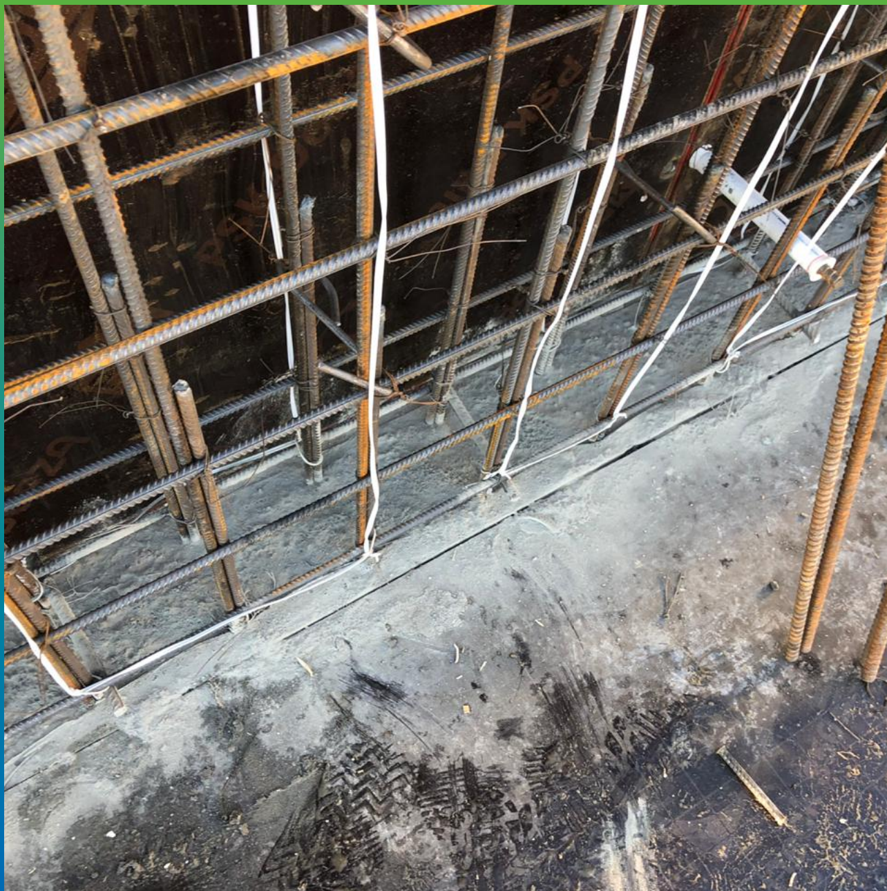
Прогидроизолированные холодные швы Стармекс Сил.
