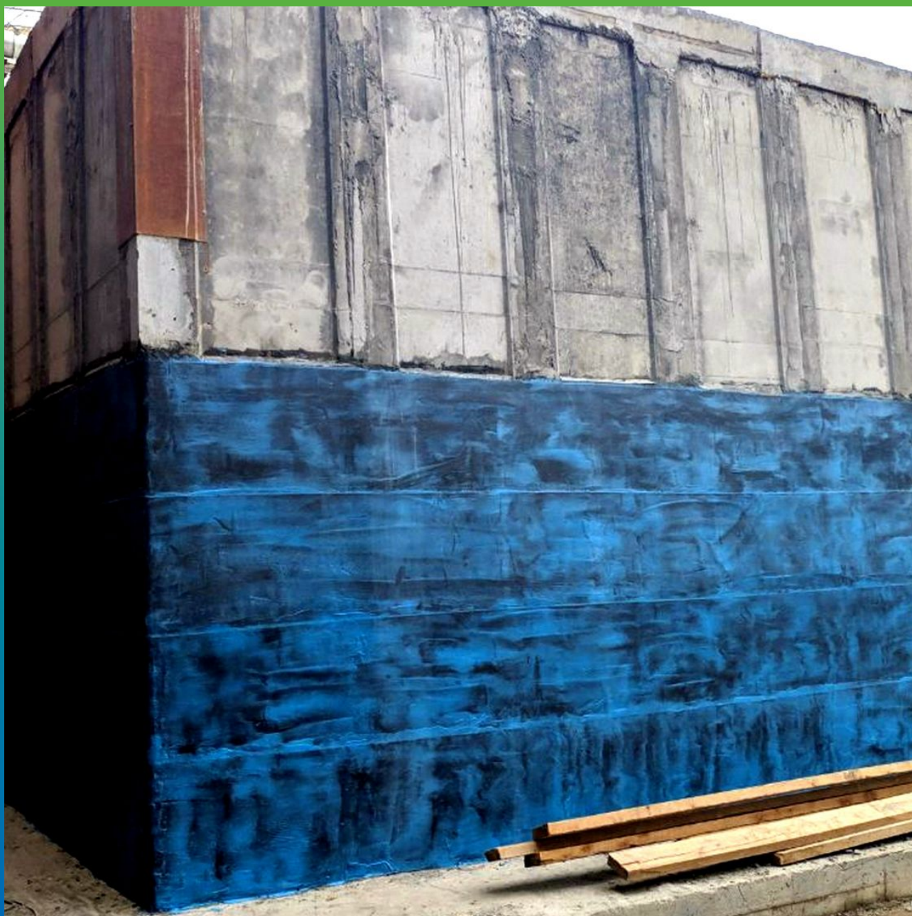
Резервуар перед наполнением водой
