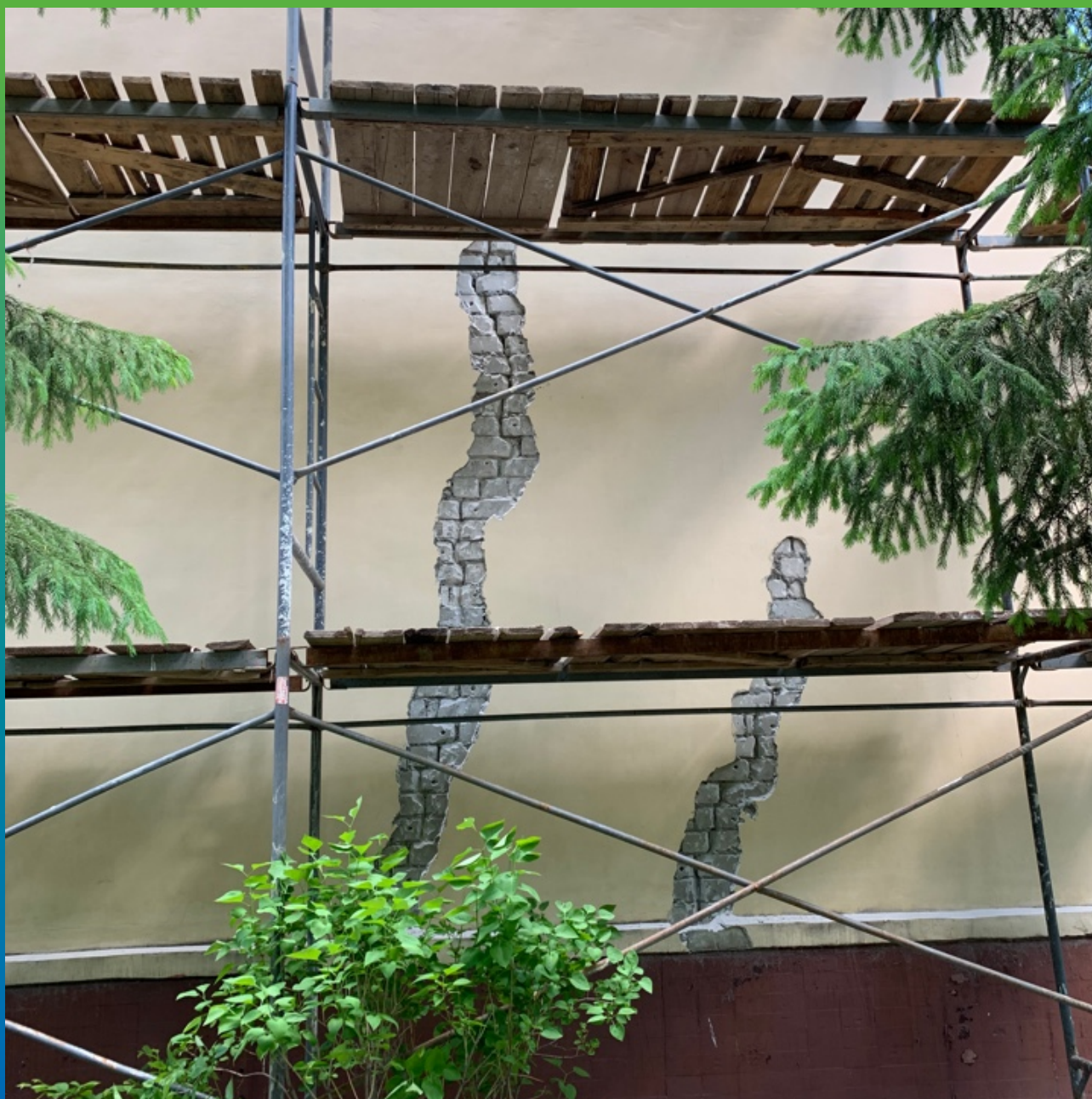
Трещины в кирпичной кладке
