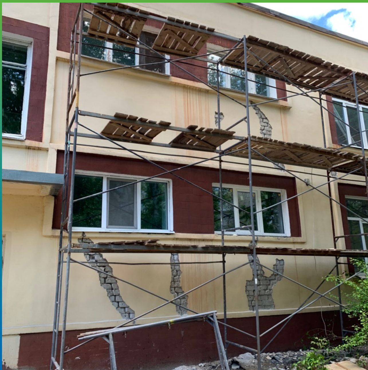
Трещины в кирпичной кладке
