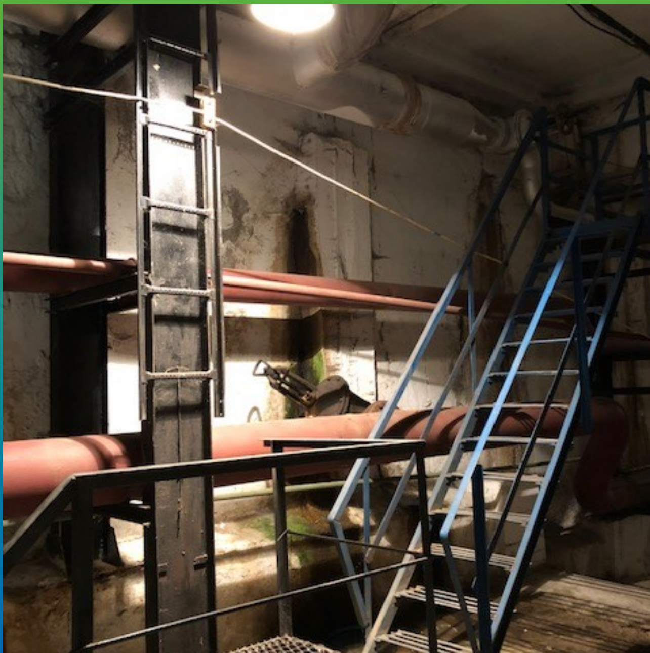
Вид участка с протечкой изнутри блока
