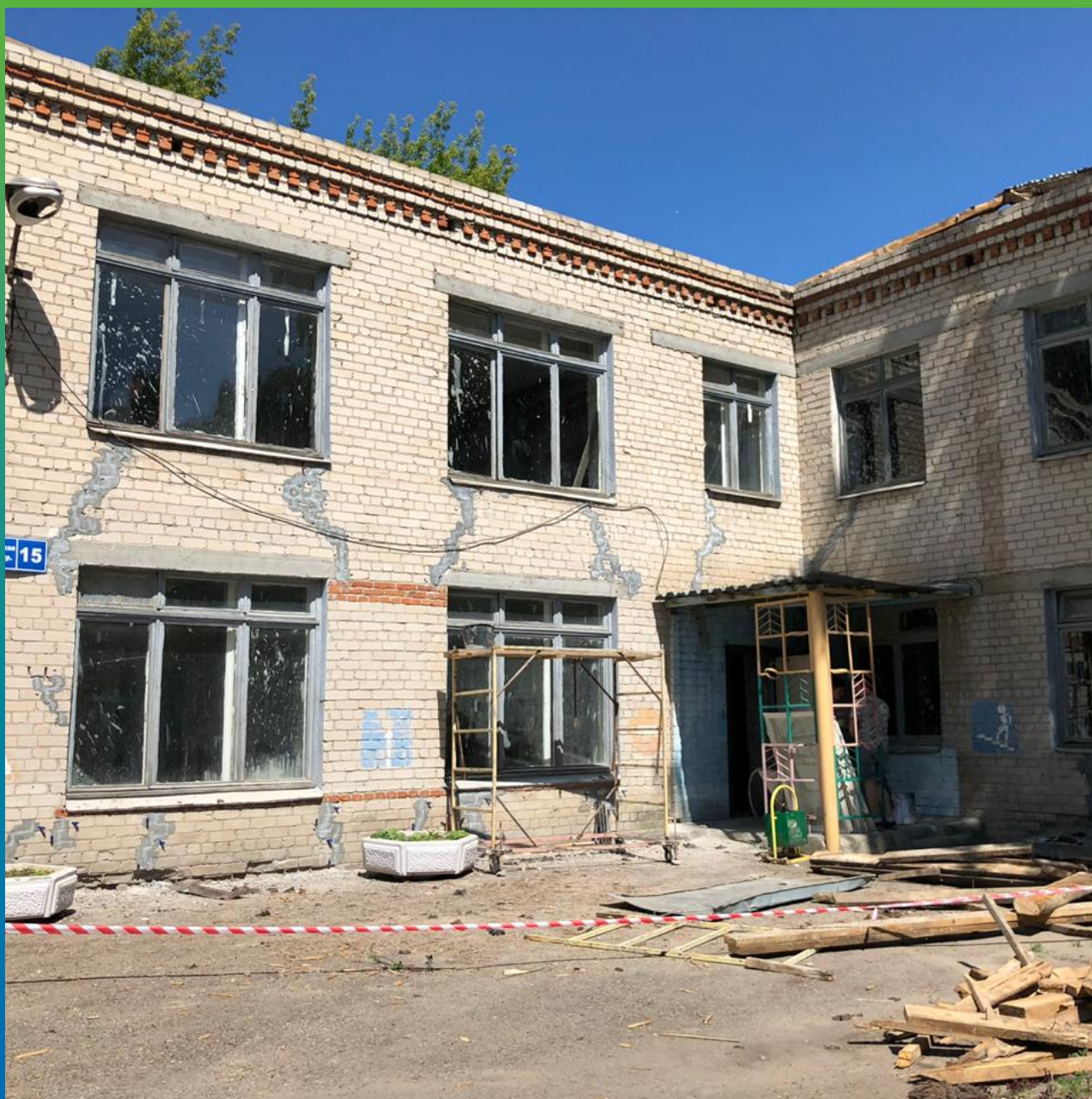
Трещины на фасаде, подготовленные к инъектированию
