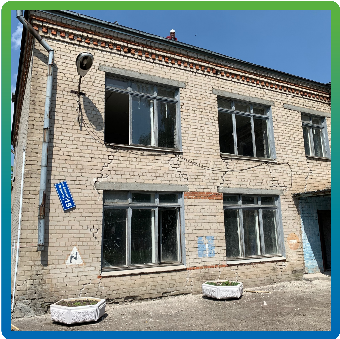
Трещины на фасаде здания
