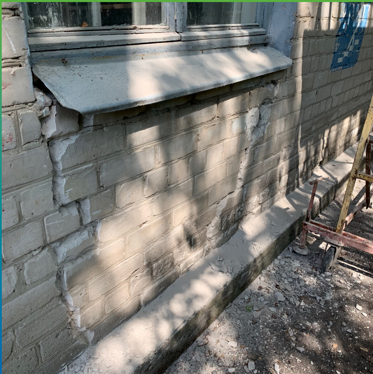
Трещины на фасаде здания
