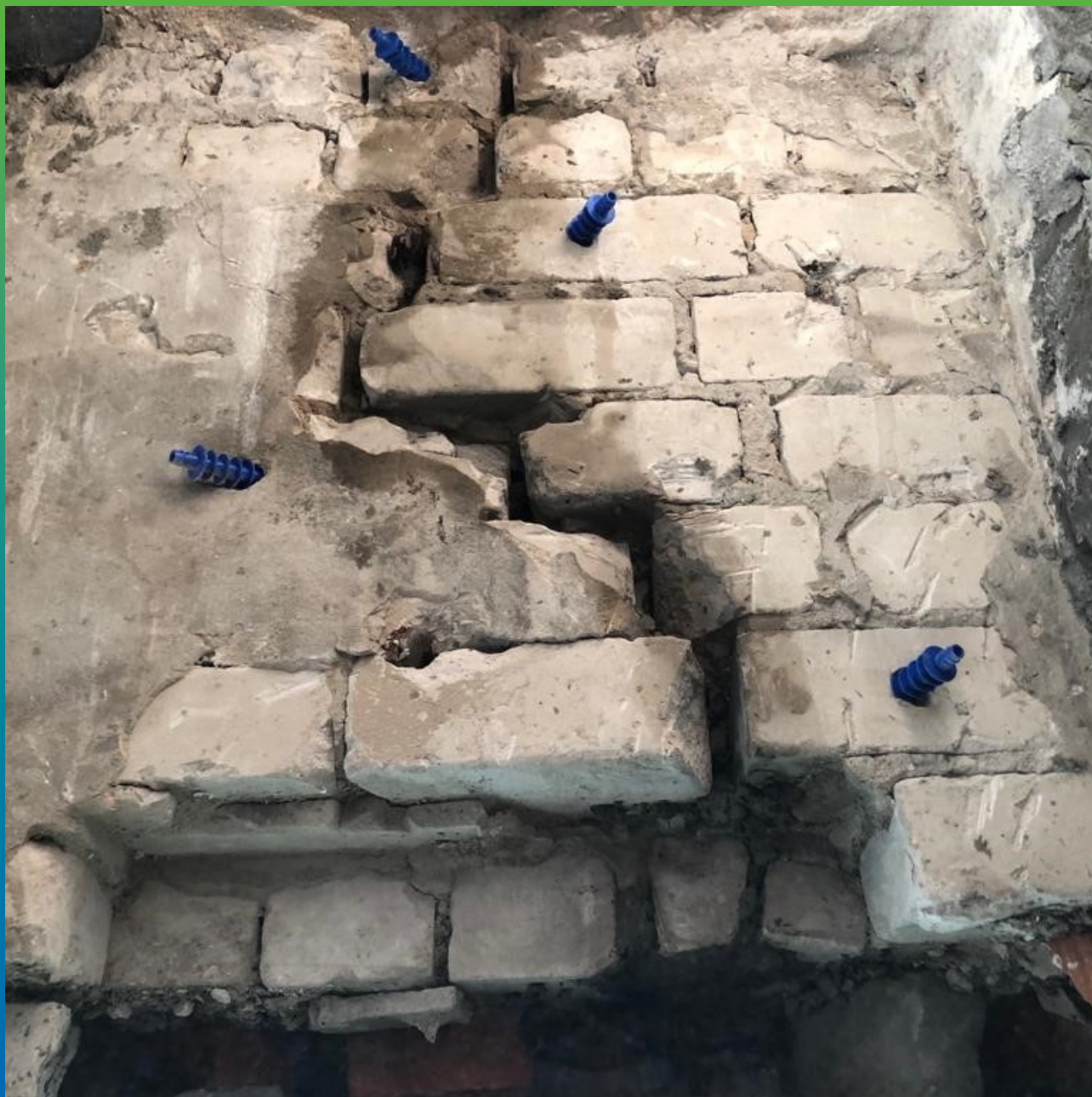
Трещина, подготовленная к зачеканке составом Стармекс РМЗ
