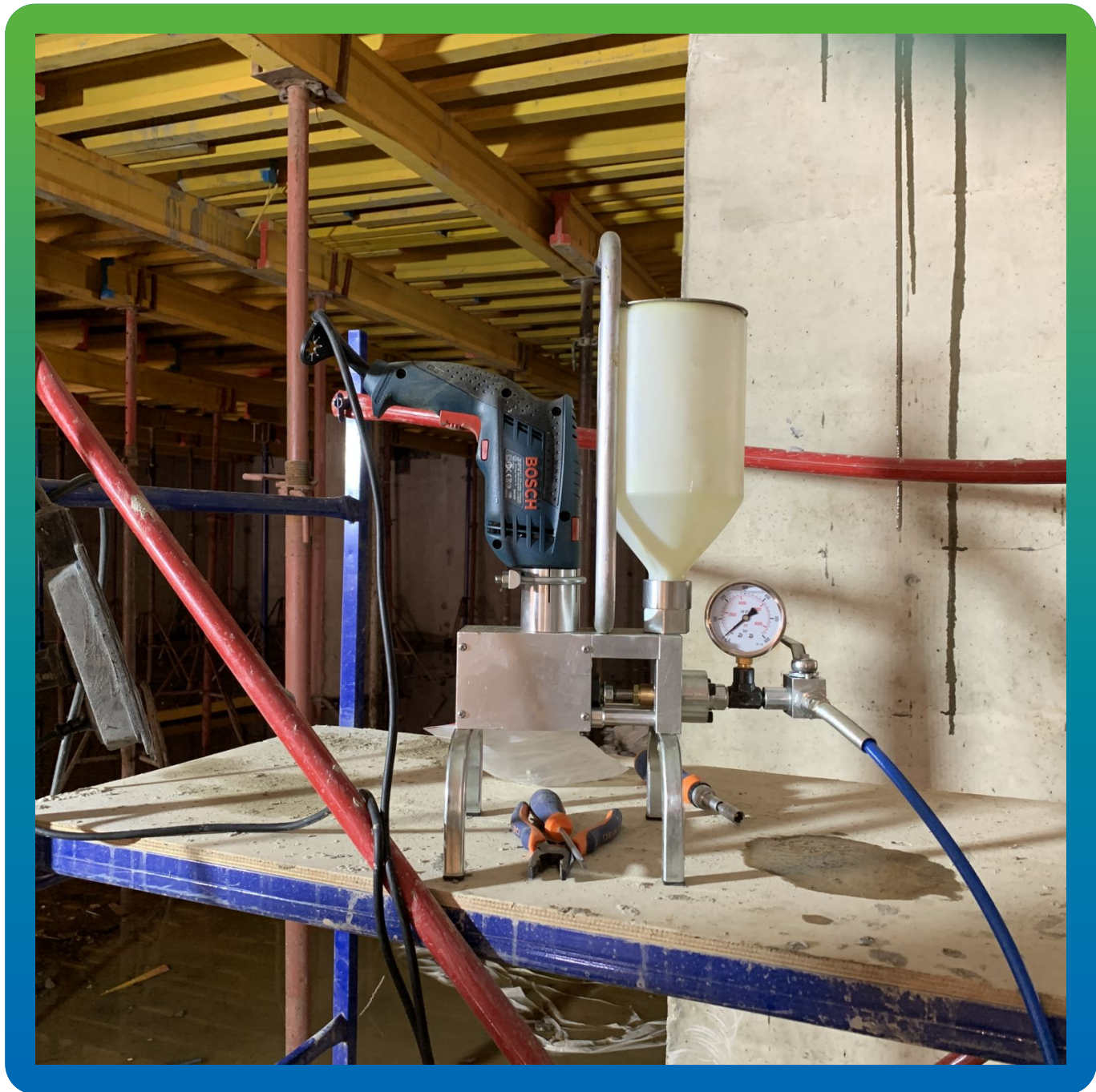
Насос БМ 0401 в работе.
