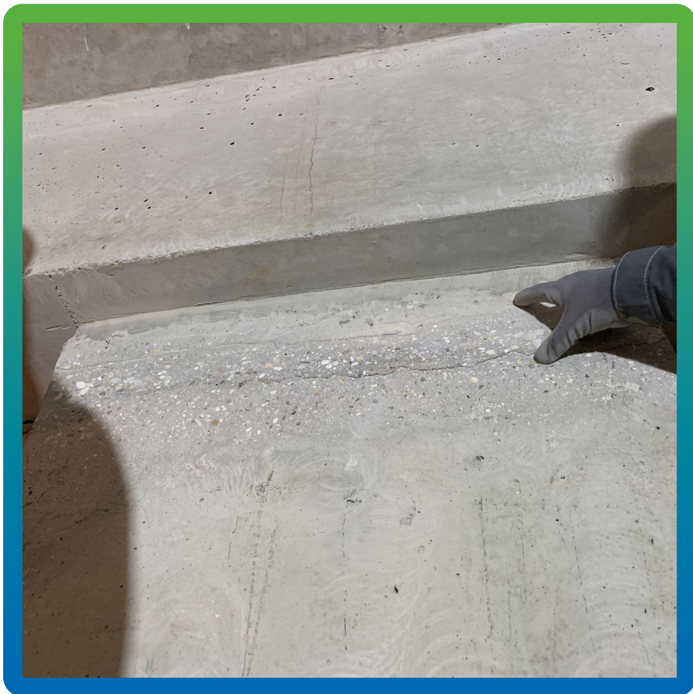
Осмотр трещины и определение необходимого количества пакеров.
