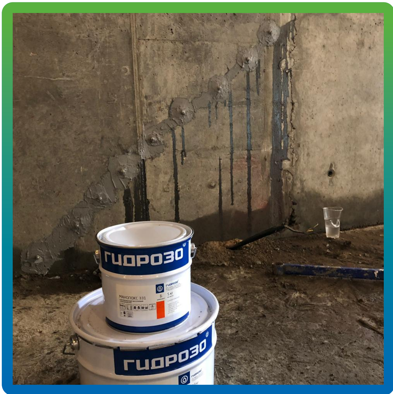
Трещина, прокаченная составом Манопокс 352
