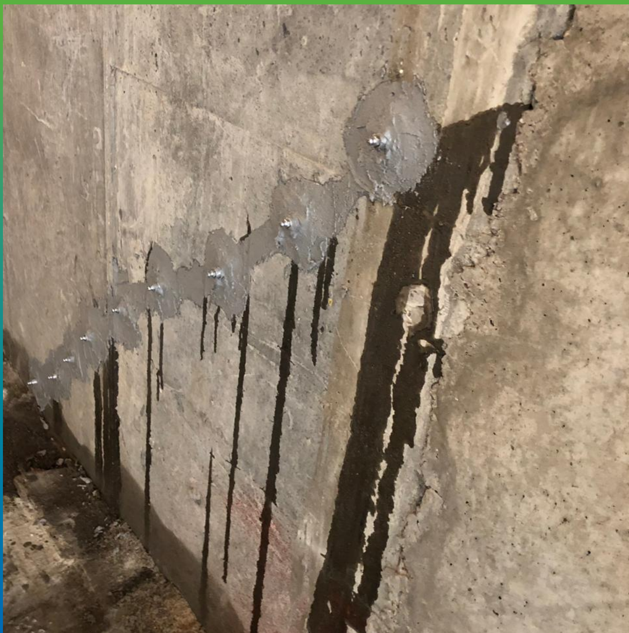
Трещина, прокаченная составом Манопокс 352
