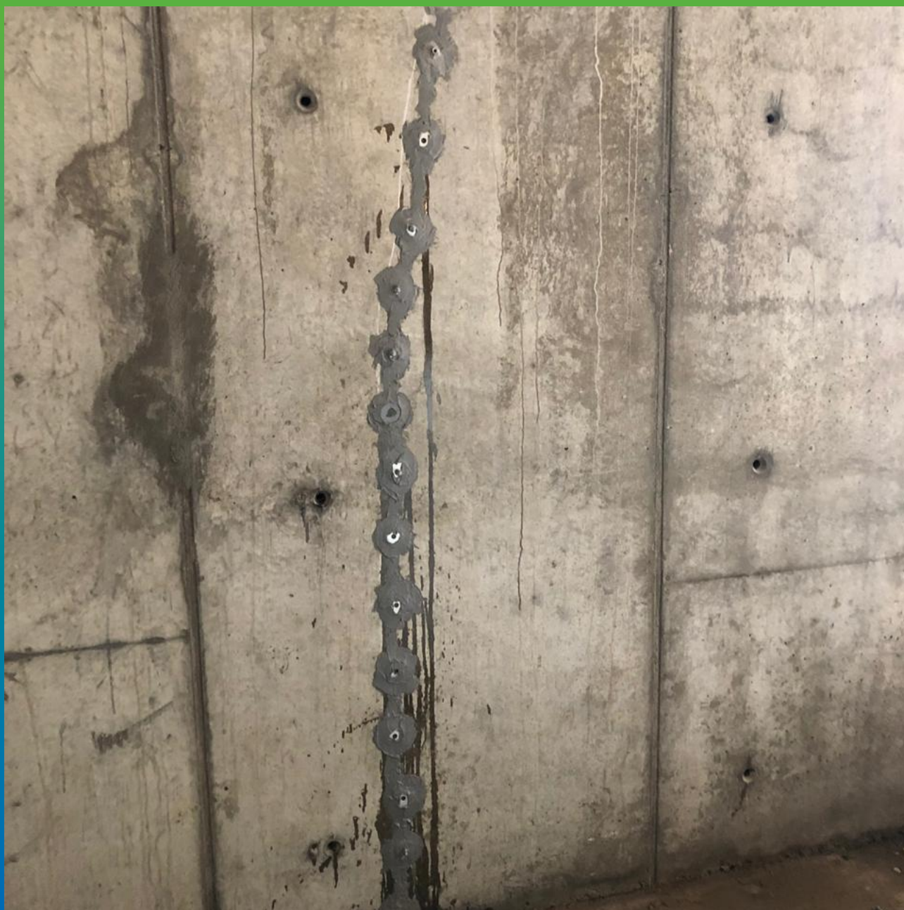
Трещина, прокаченная составом Манопокс 352
