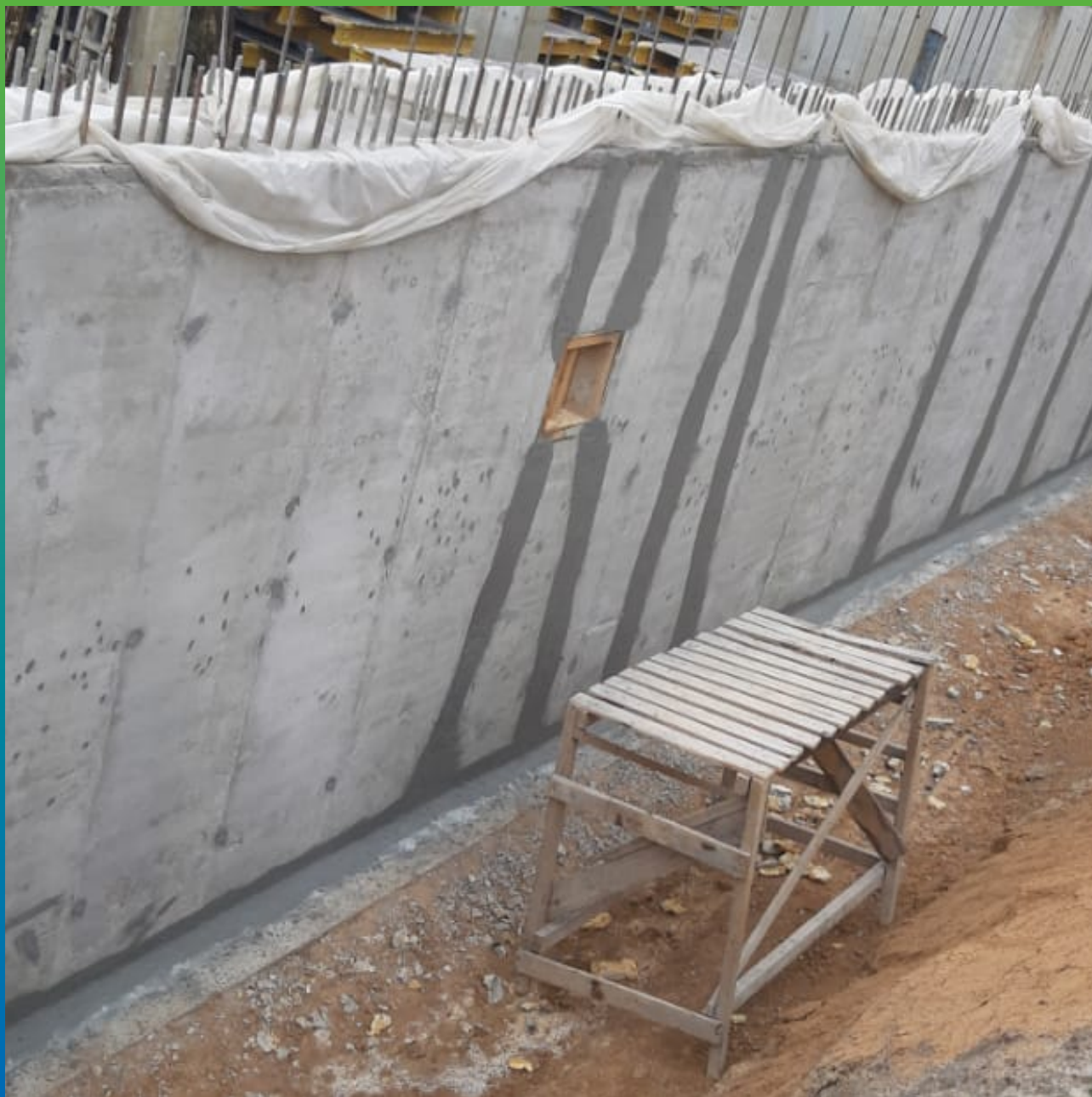
Зачеканенные Стармекс РМЗ холодные швы и трещины
