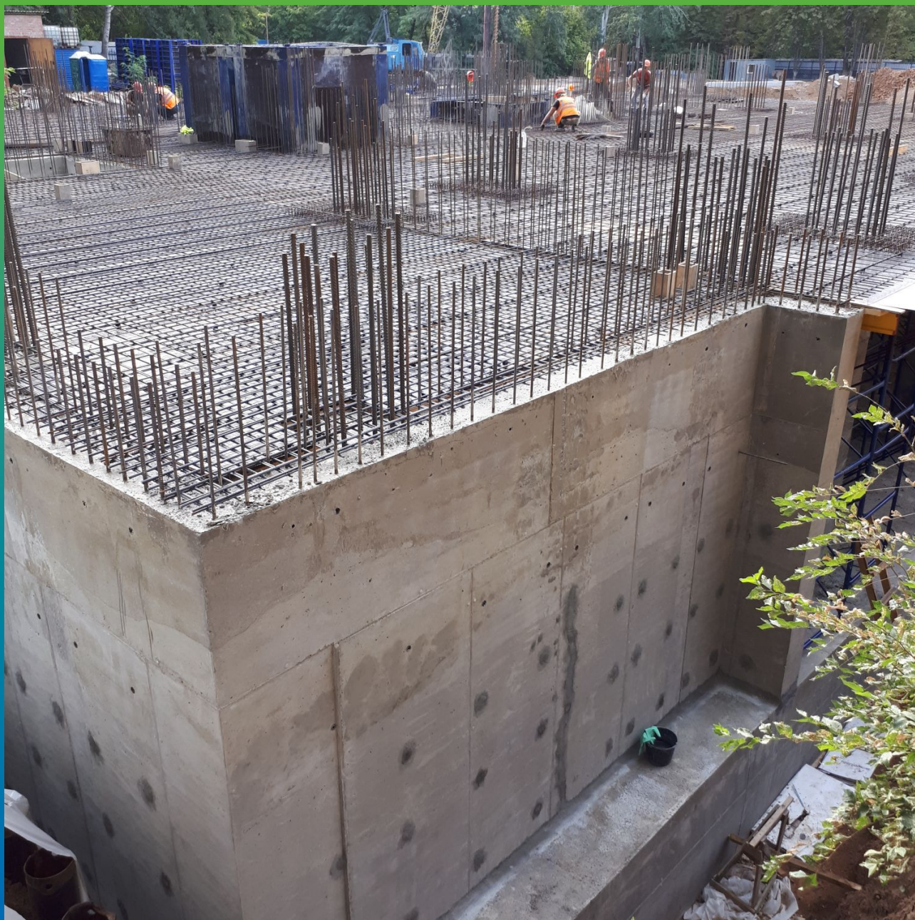
Выполненное примыкание плита-стена и заделка отверстий от опалубки рем. составом Стармекс РМЗ
