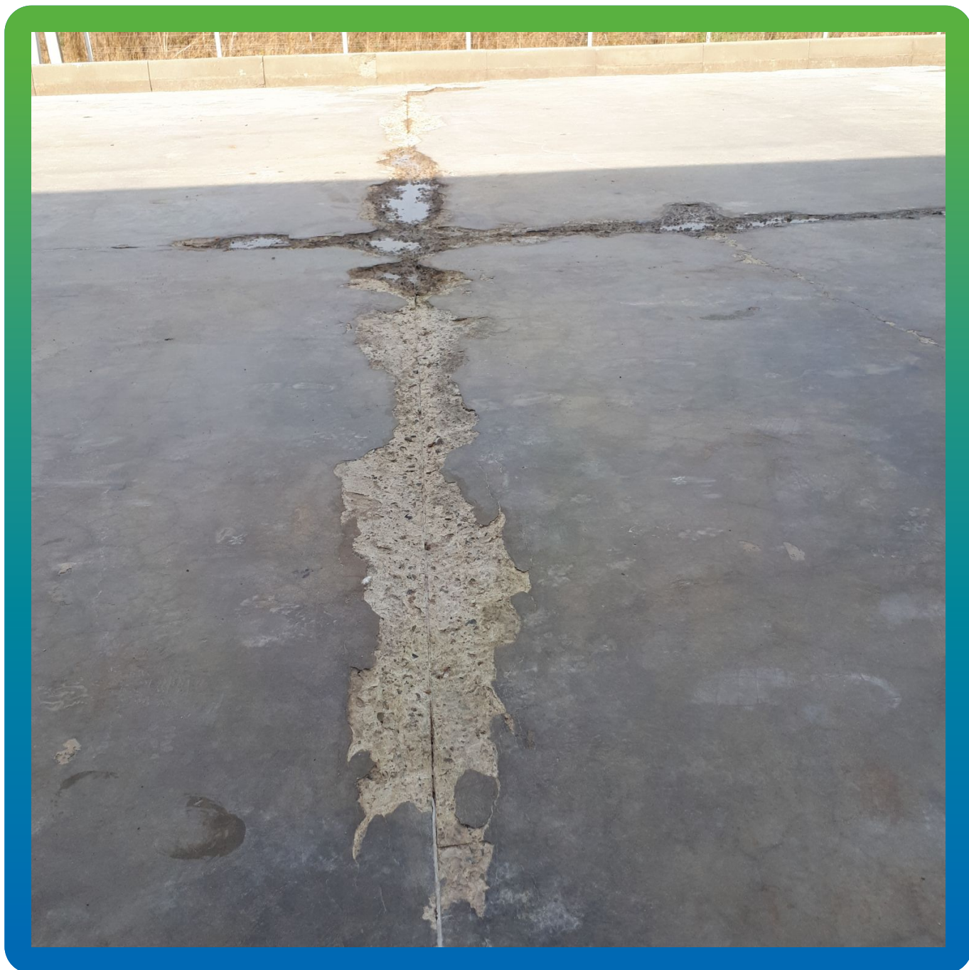
Разрушение бетона в районе швов
