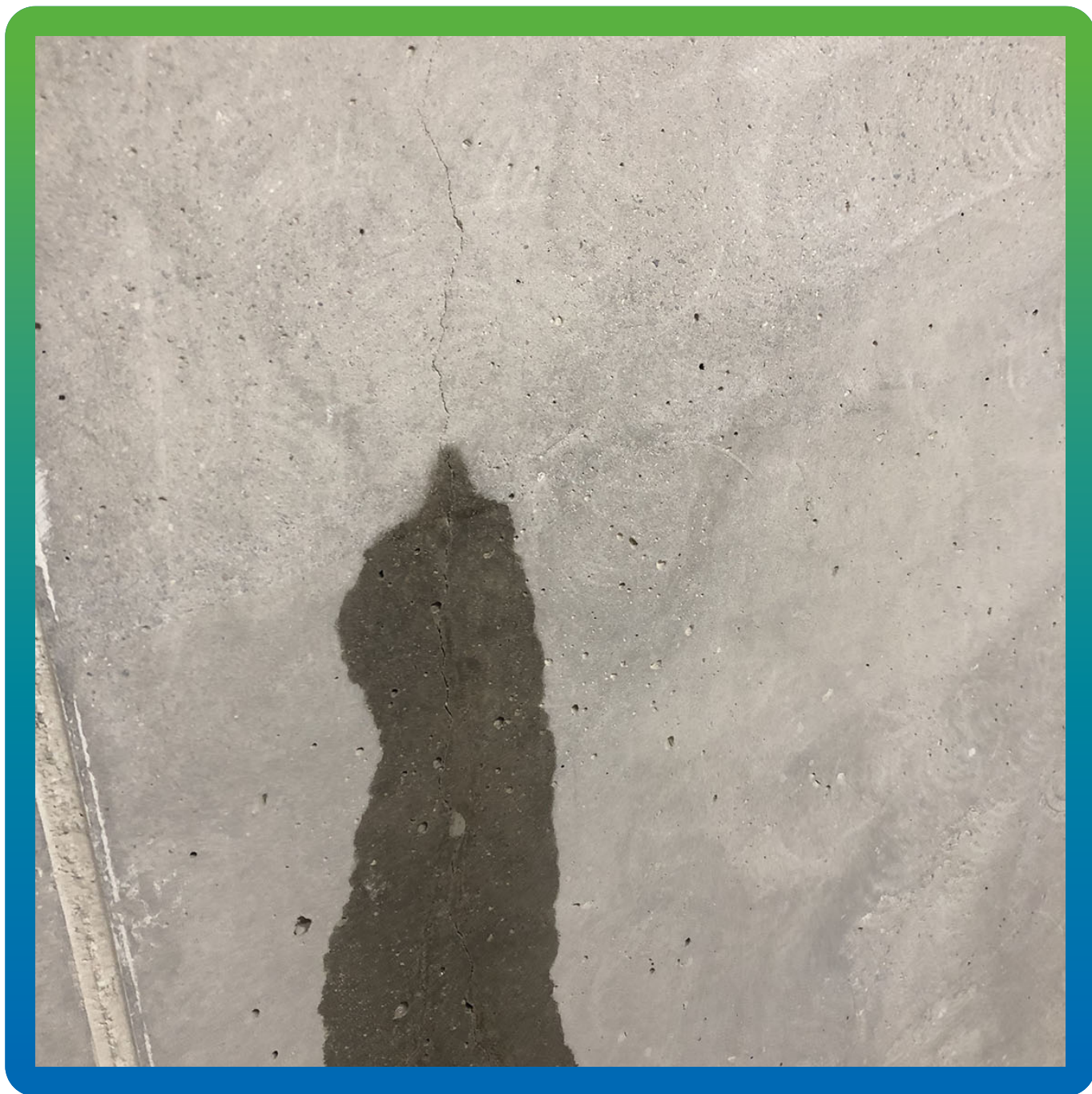
Трещины с активными протечками в стенах парковки
