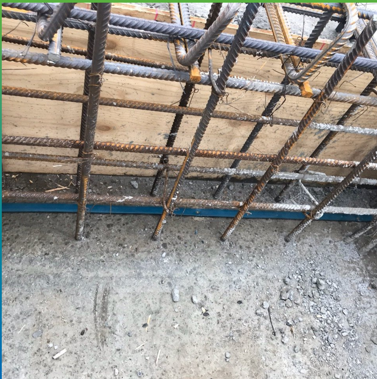
Гидрофильный профиль Манодил Свелл ХК 2507 по периметру "холодных швов" лифтовых прямков
