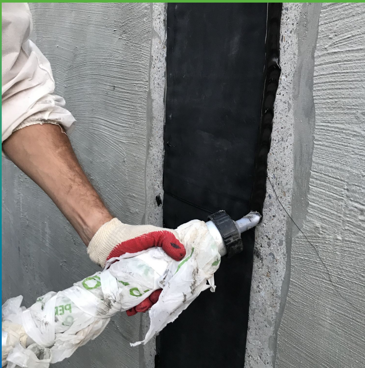
Гидроизоляция теплового контура при помощи ЭПДМ- мембраны Прелести СТ и Витрафин Бонд Ф
