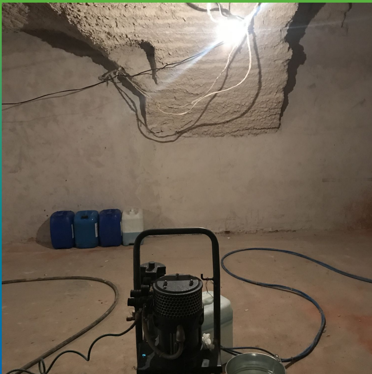
Стена после проведения работ по созданию объемного отсечного барьера против поднятия влаги из фундамента и грунта
