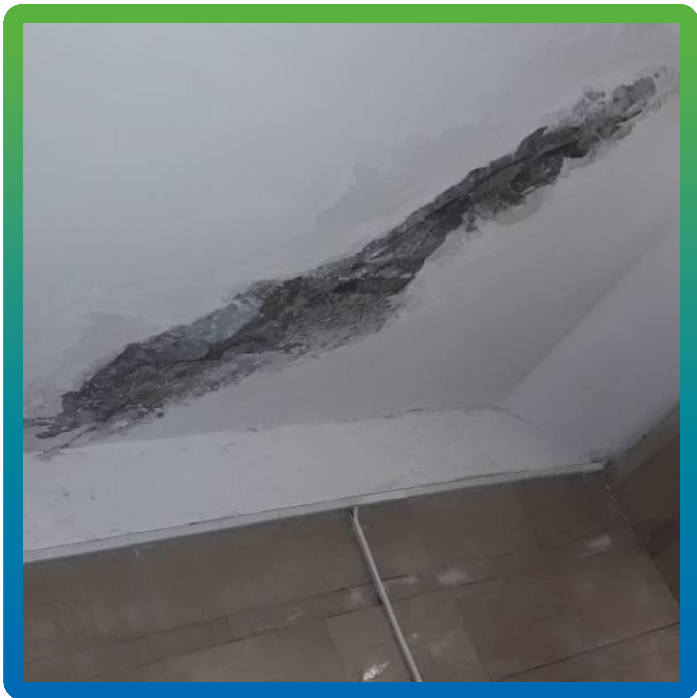
Трещина с протечкой
