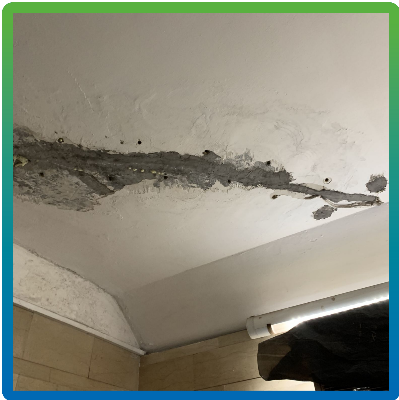
Вид трещины после инъектирования
