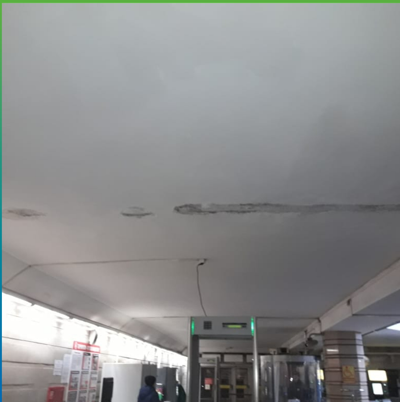
"Холодный шов" бетонирования с протечками
