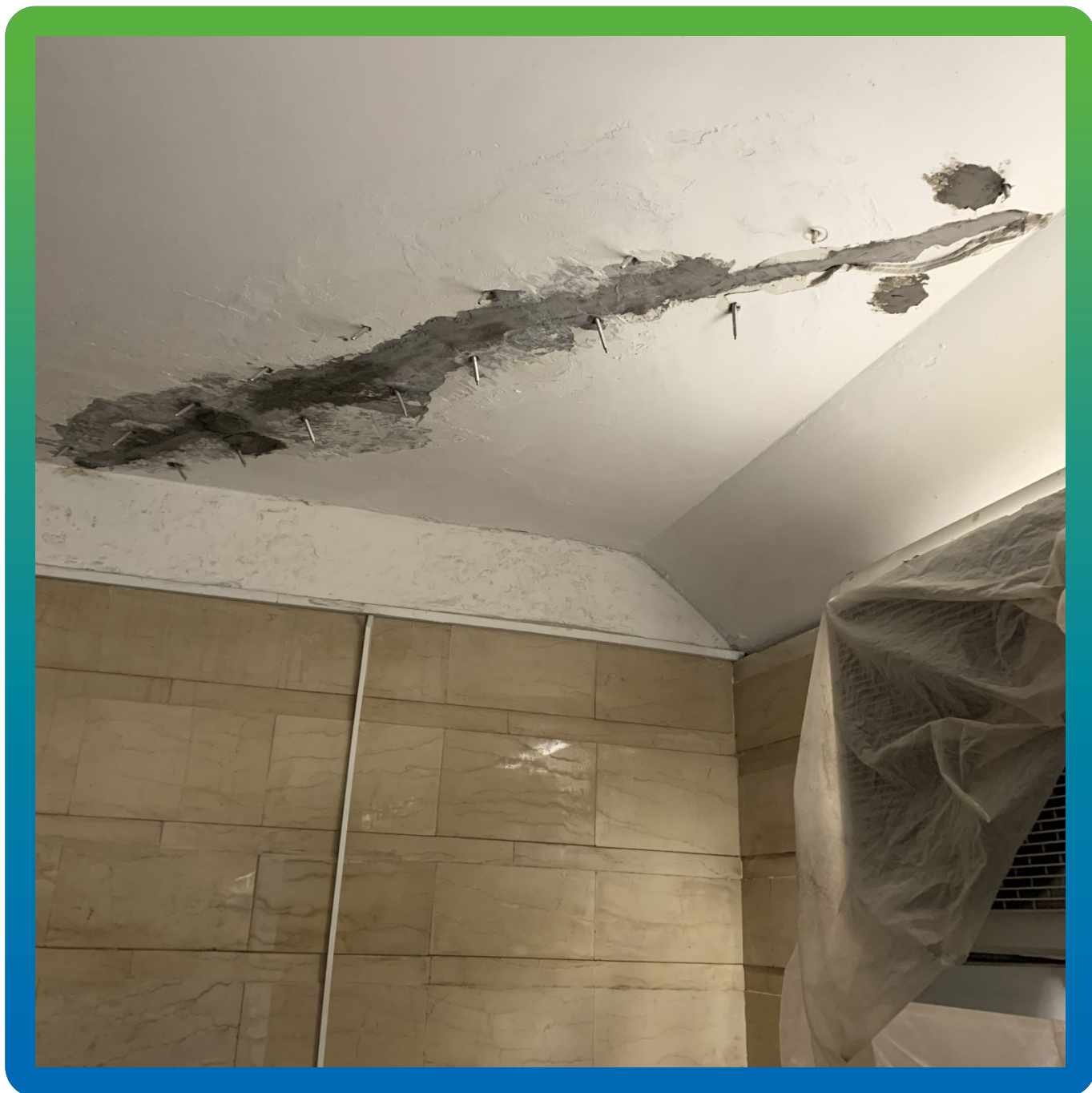
Трещина, подготовленная к инъектированию
