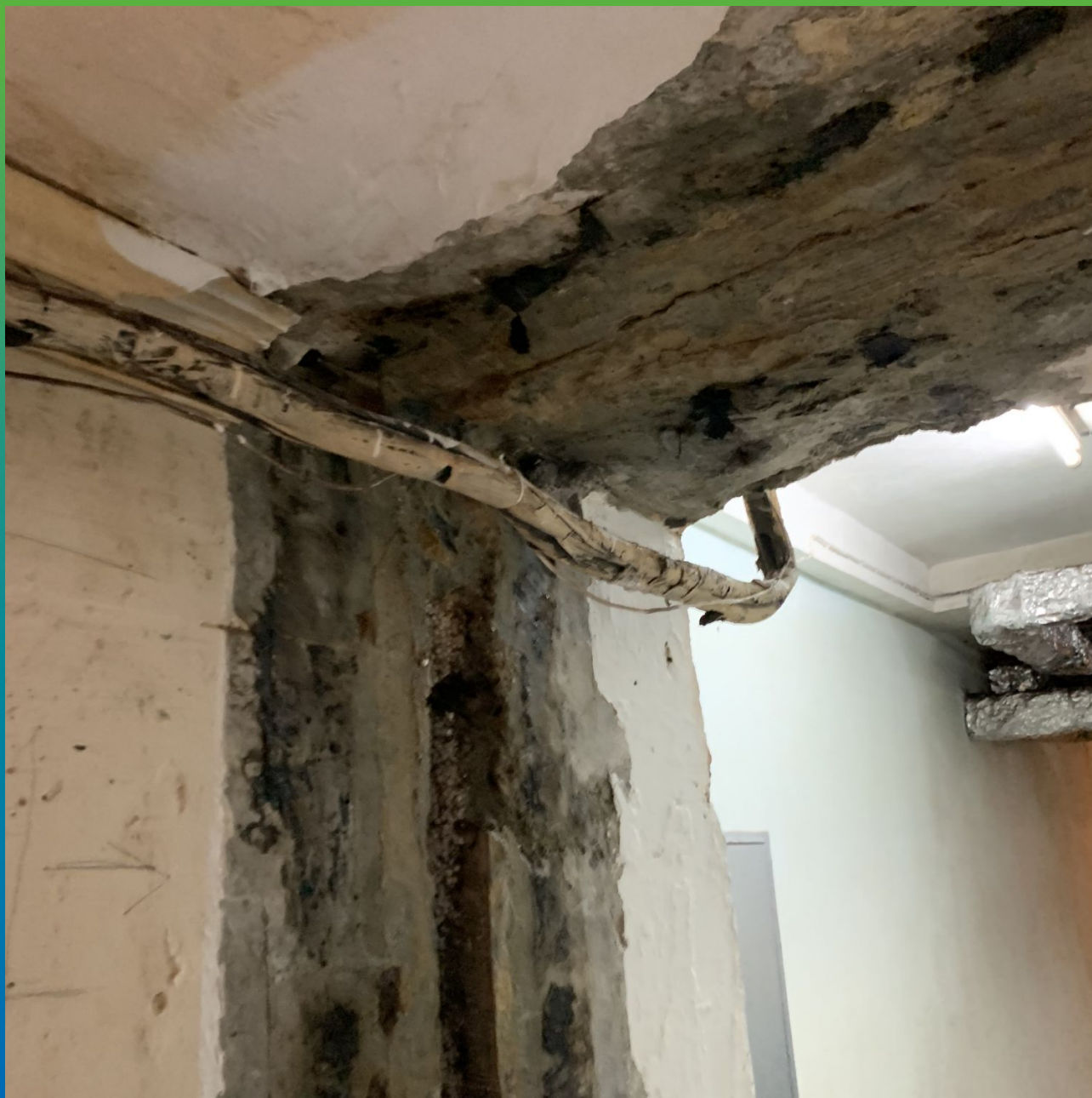
Вид деформационного шва до проведения работ
