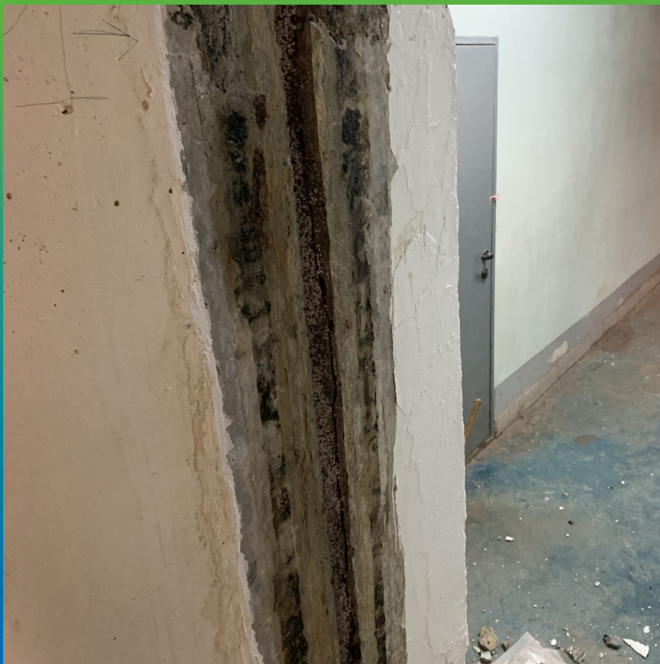
Вид деформационного шва до проведения работ
