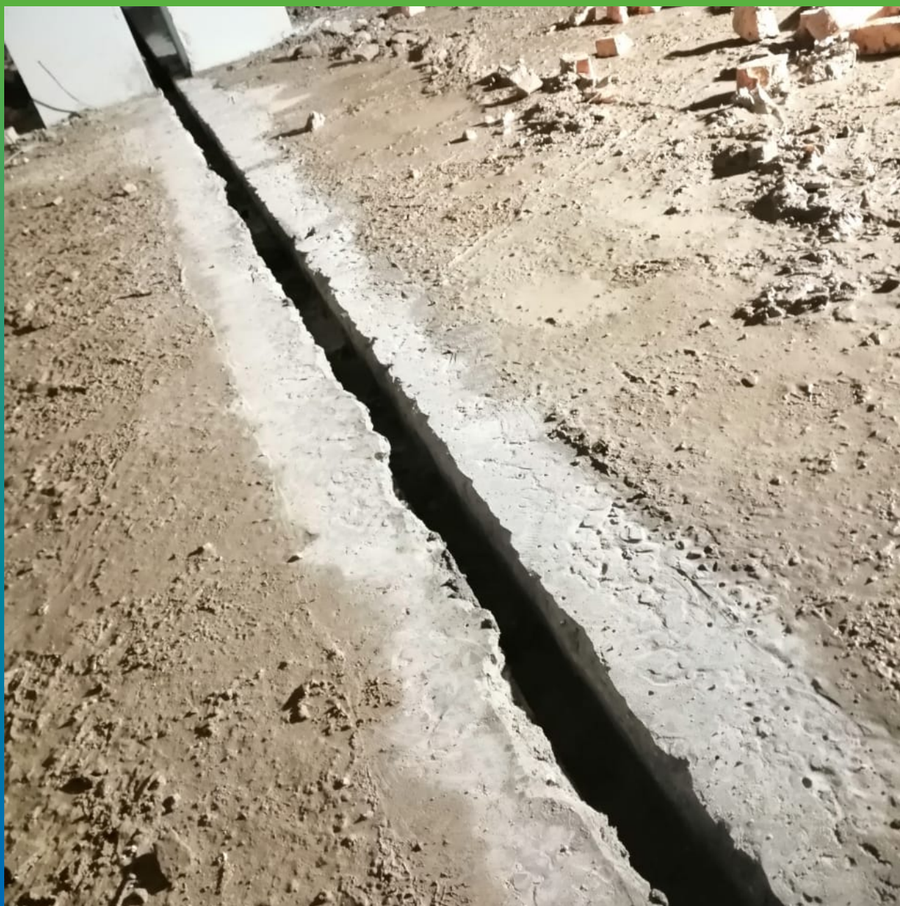
Зашлифованная поверхность кромок шва
