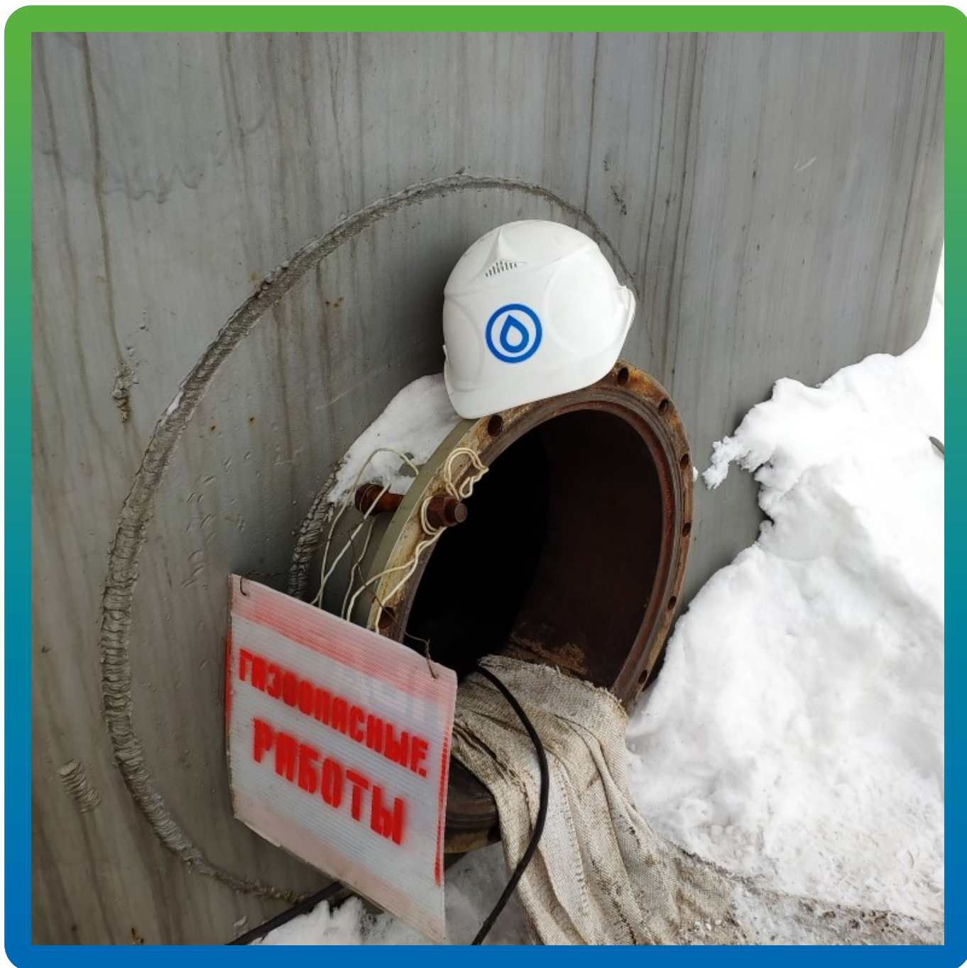
Резервуар хранения метанола.
