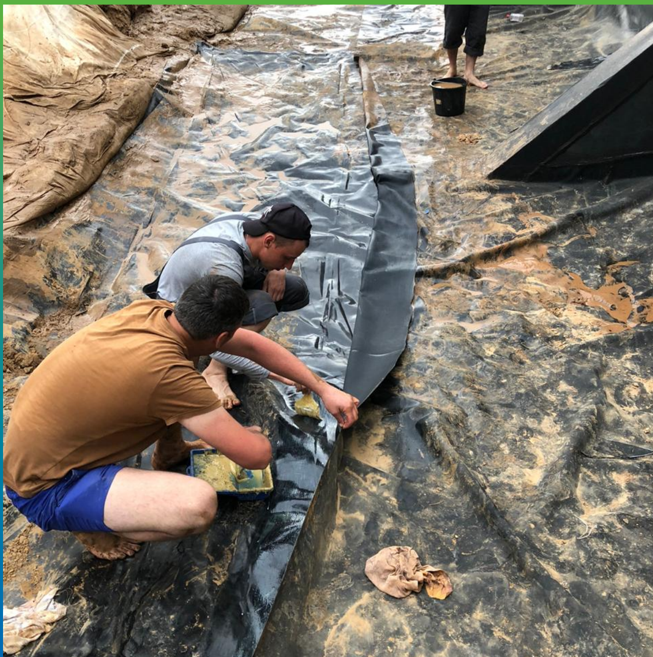
Соединение старого гидроизоляционного покрытия и Преласты СТ на адгезив П400 и Манодил Бонд Ф.
