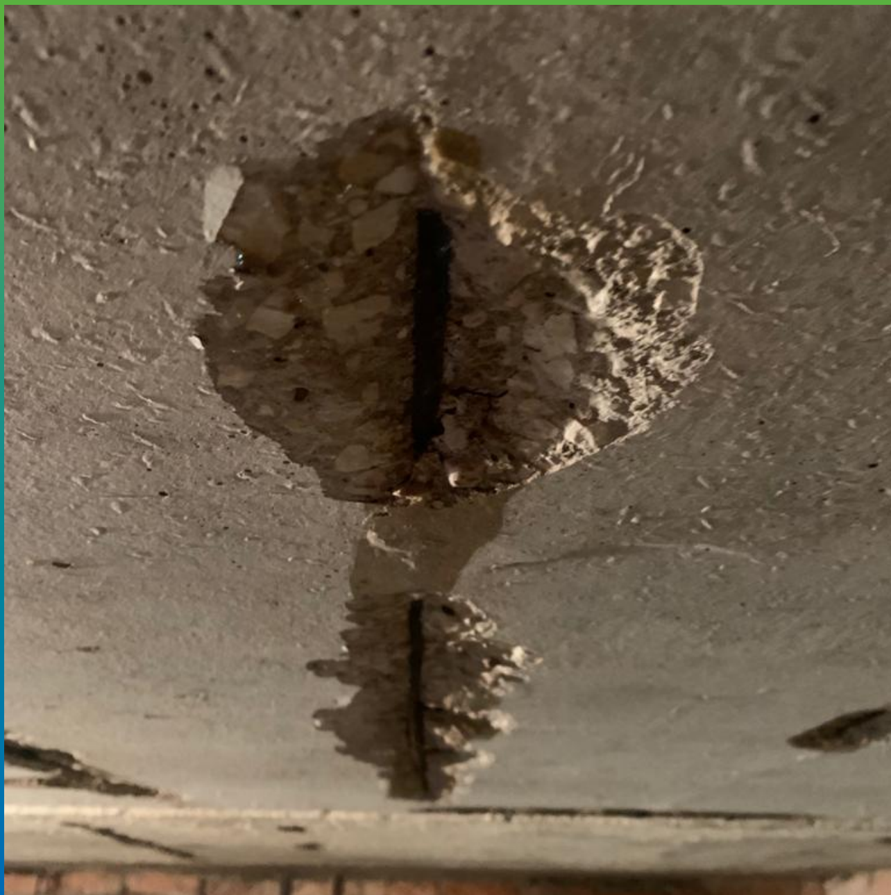
Зачищенные участки с корродированной арматурой.
