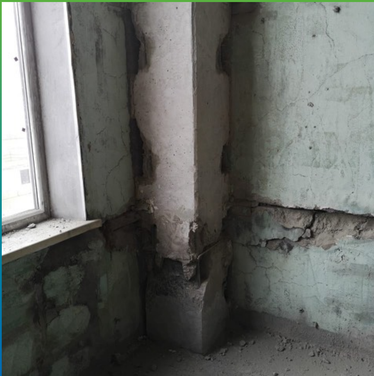
Общий вид колонны до проведения ремонтных работ
