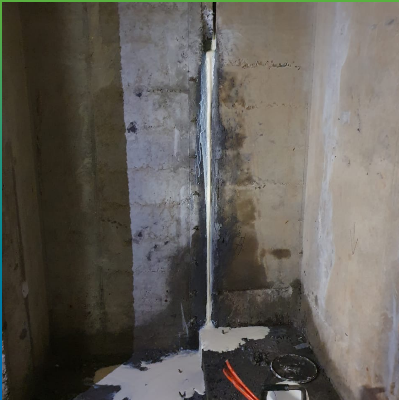
Процесс инъектирования Манопур С в стену
