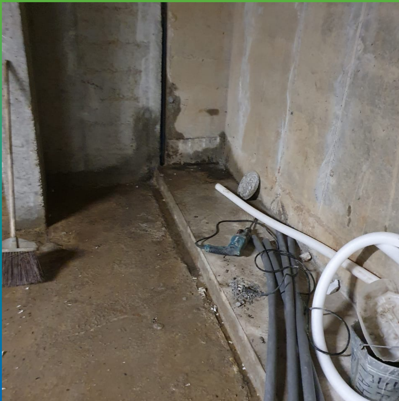
Зона намокания деформационного шва
