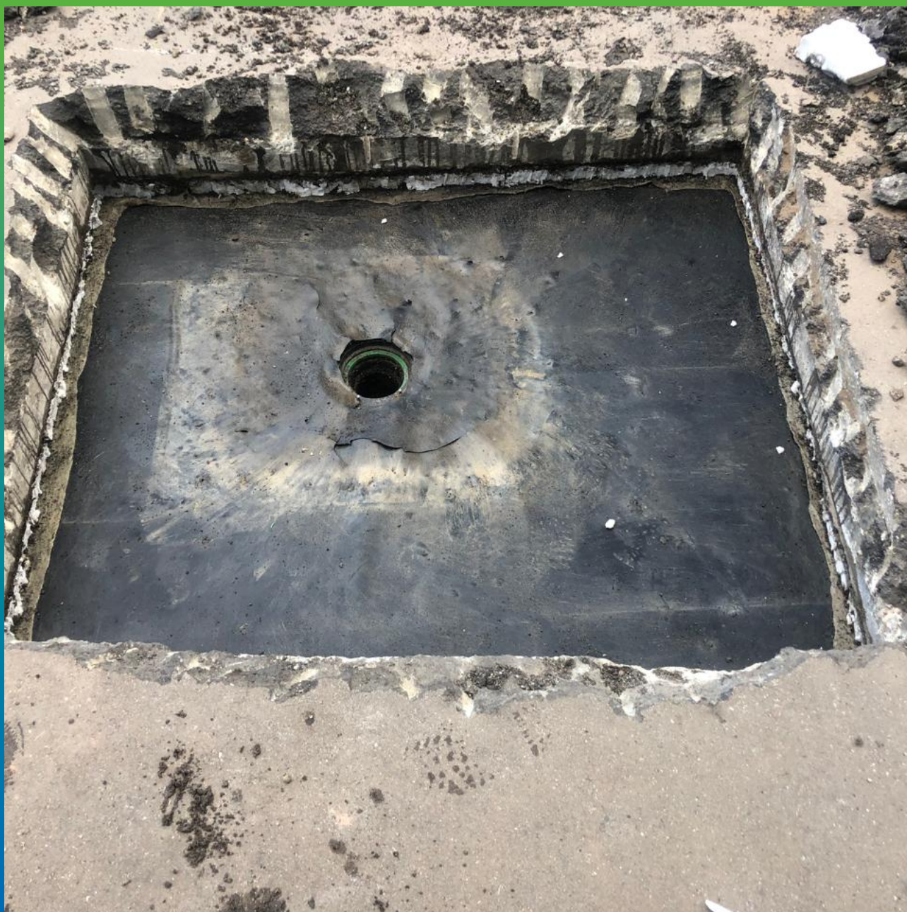
Вскрытые участки для ремонта примыканий и дефектов при асфальтировании
