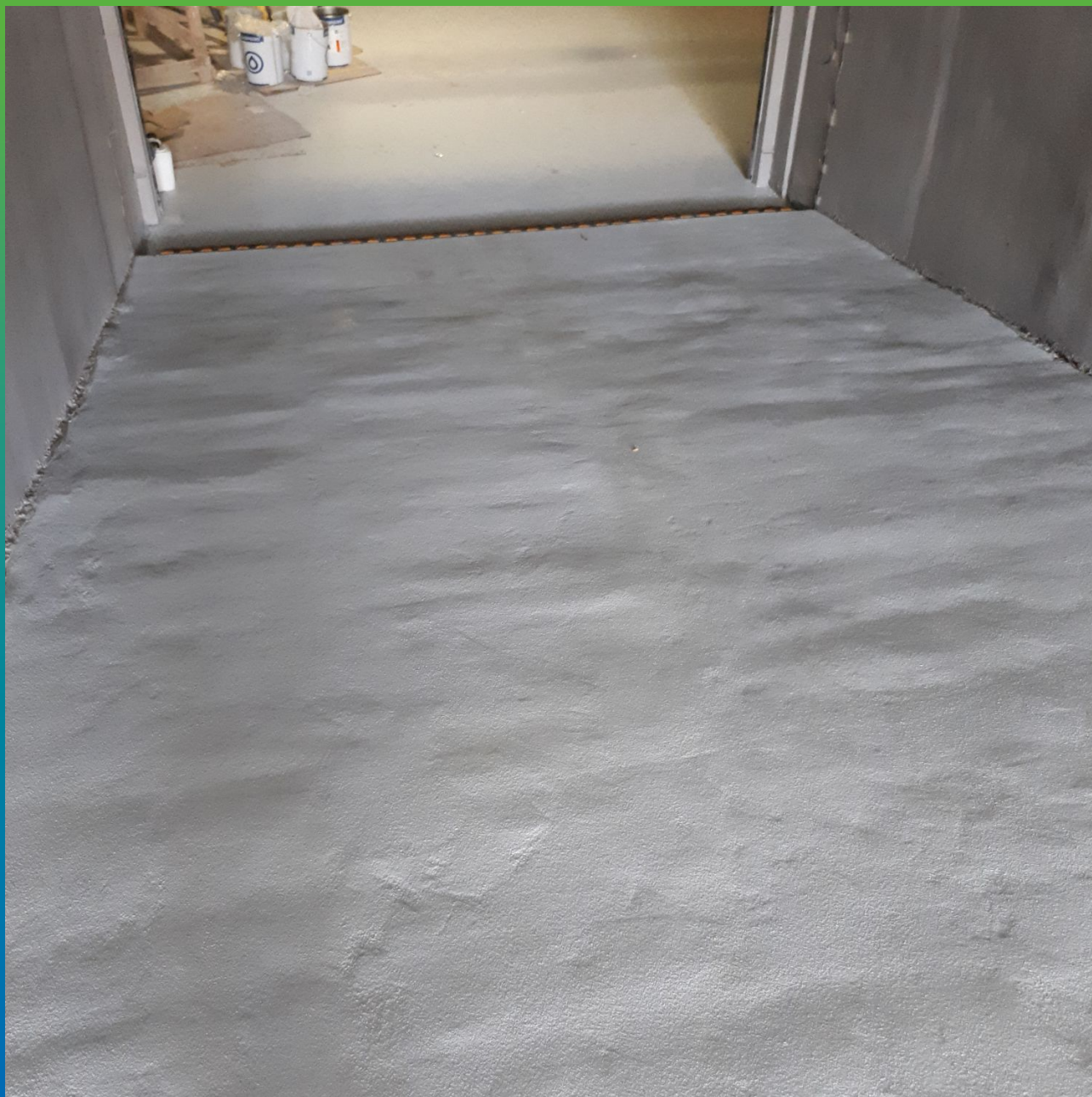
Нескользящее покрытие с песком разной фракции на въездной рампе
