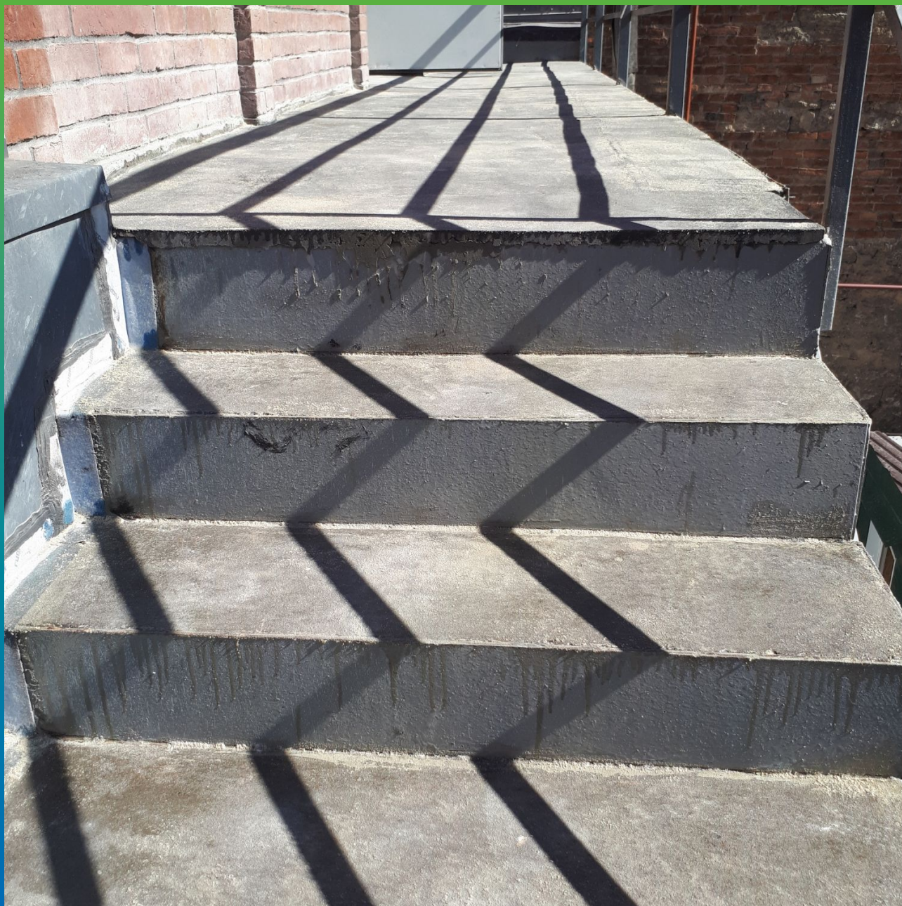
Нескользящее покрытие ж.б. ступеней и площадки эпоксидным составом ДенсТоп ЭП 400 с песком
