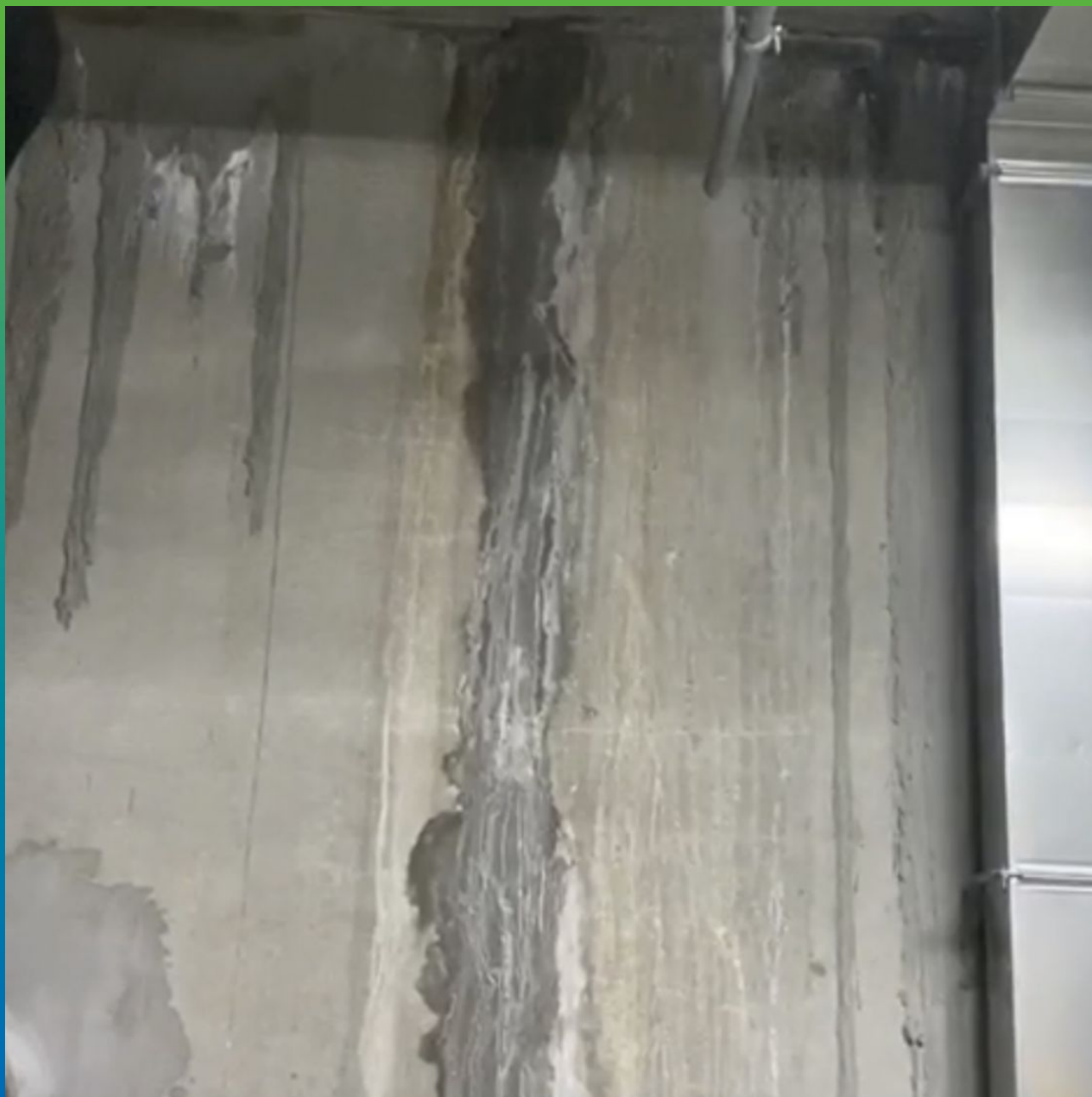
Шов до проведения работ
