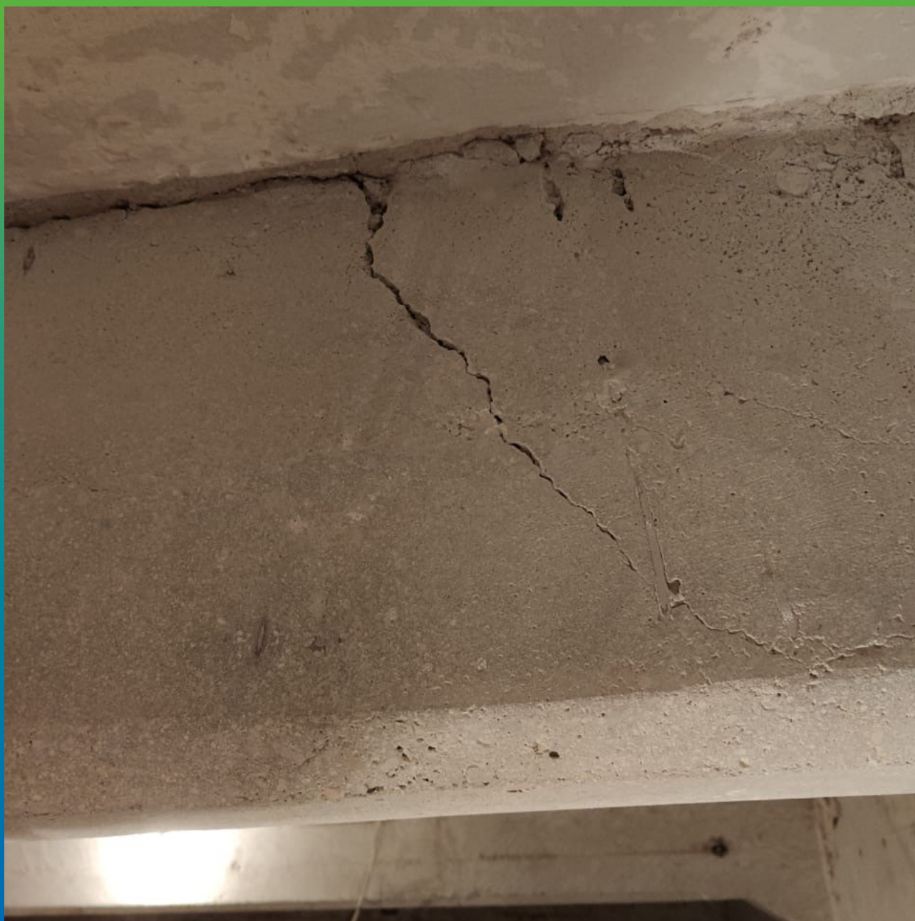
Подготовленная поверхность балки. Вид на трещину и фаску.
