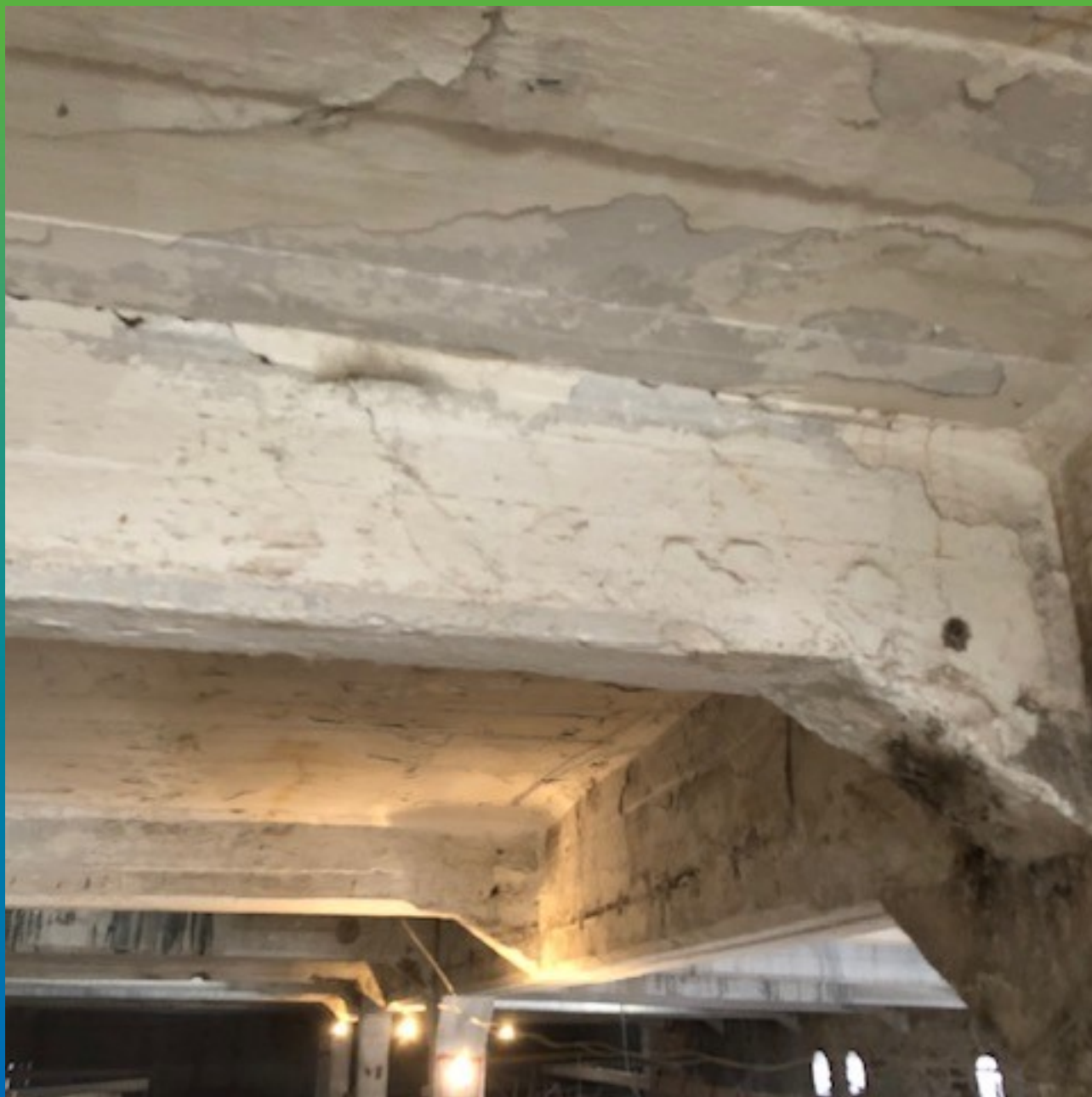
Вид трещины второстепенных балок под усиление.
