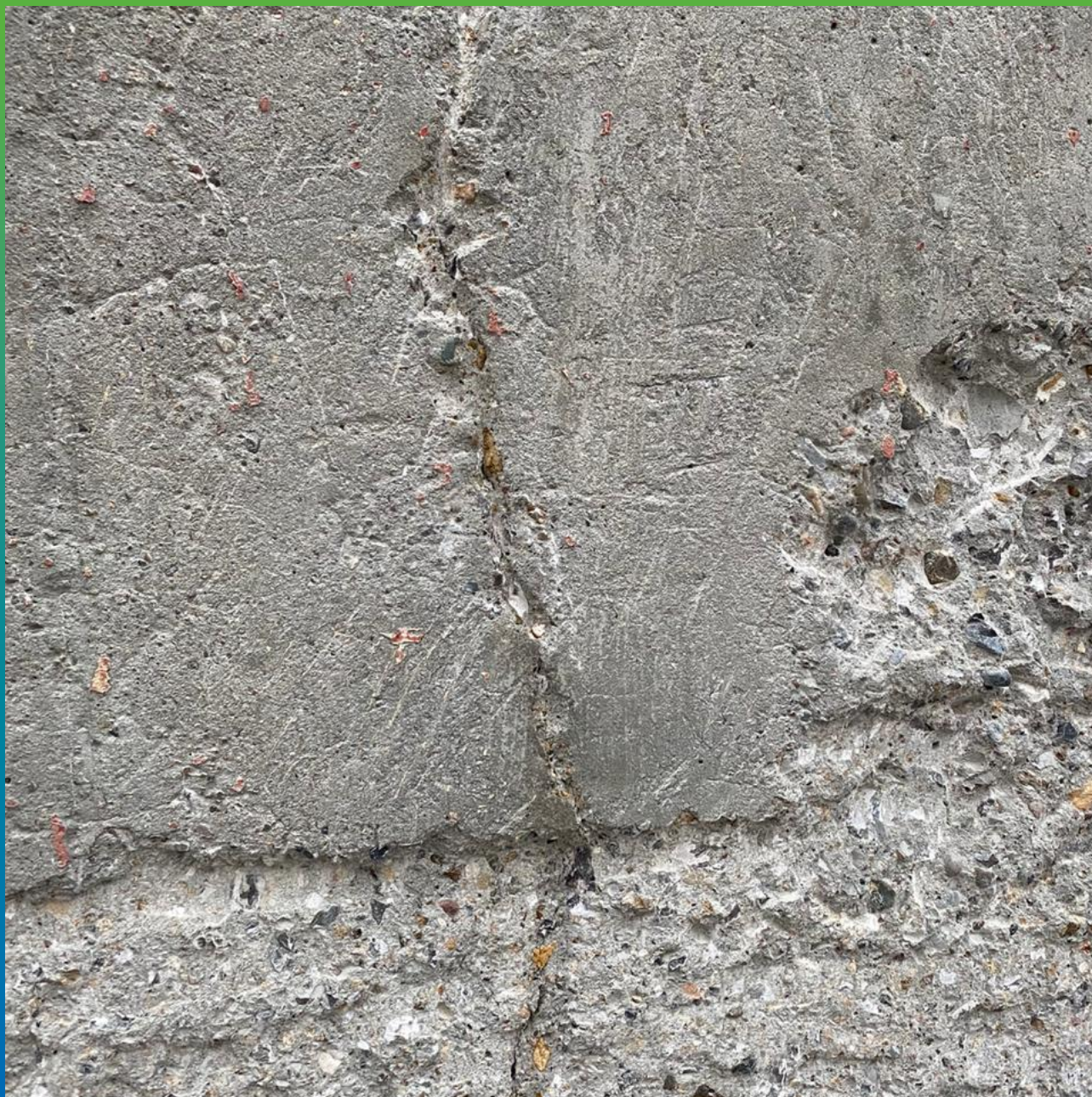
Дефекты монолитного железобетона
