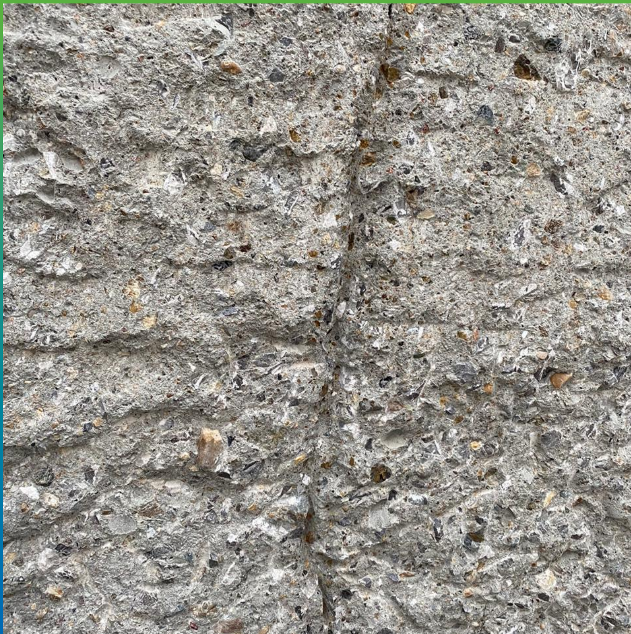
Дефекты монолитного железобетона
