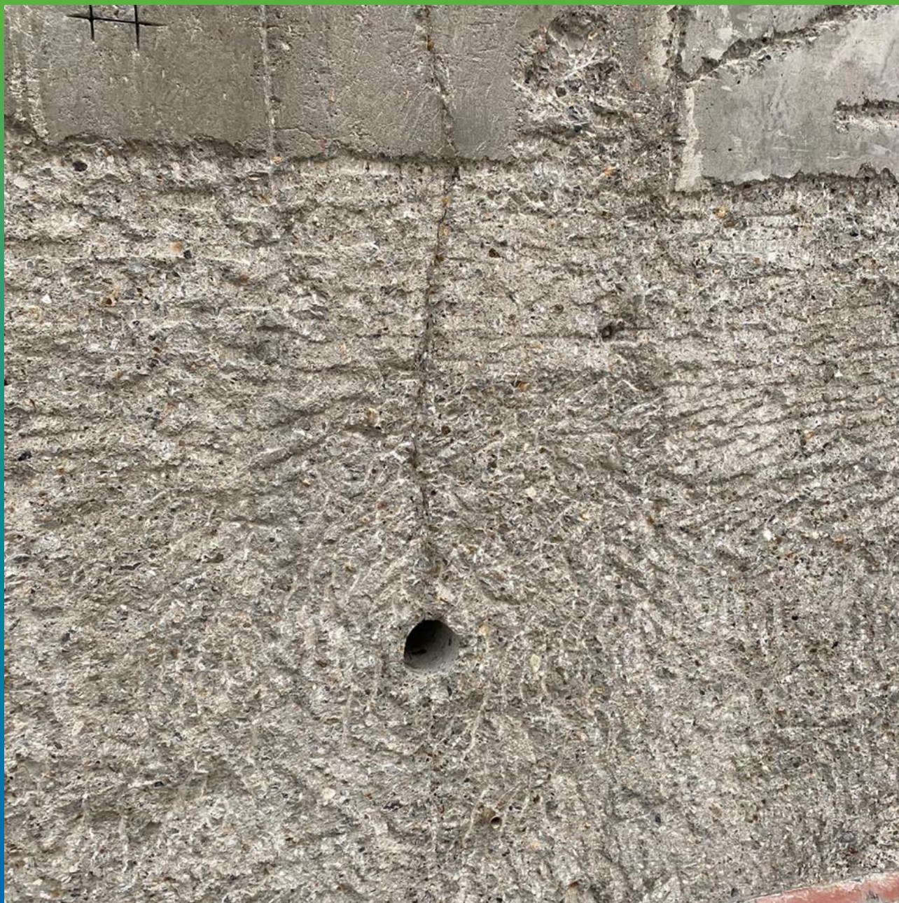
Дефекты монолитного железобетона
