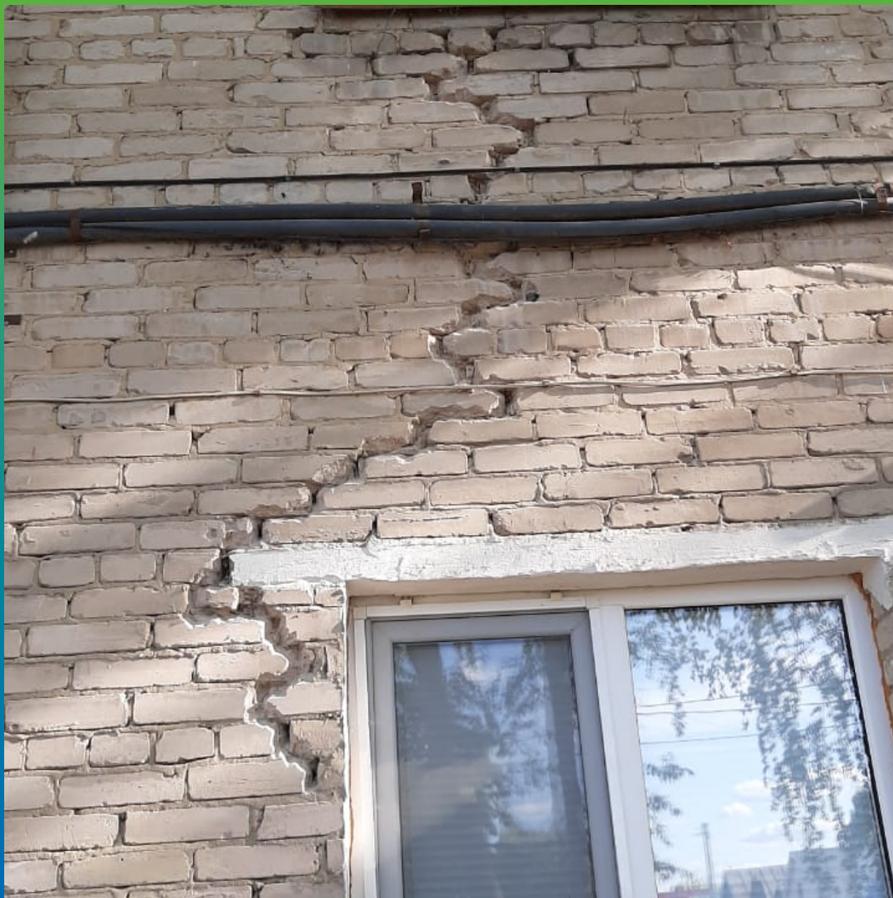
Трещины в кирпичной кладке жилого дома.
