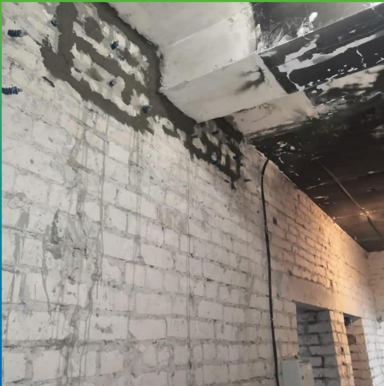
Зона усиления проема с зачеканенными Стармекс РМЗ швами и монтированными пакерами БМ 2839
