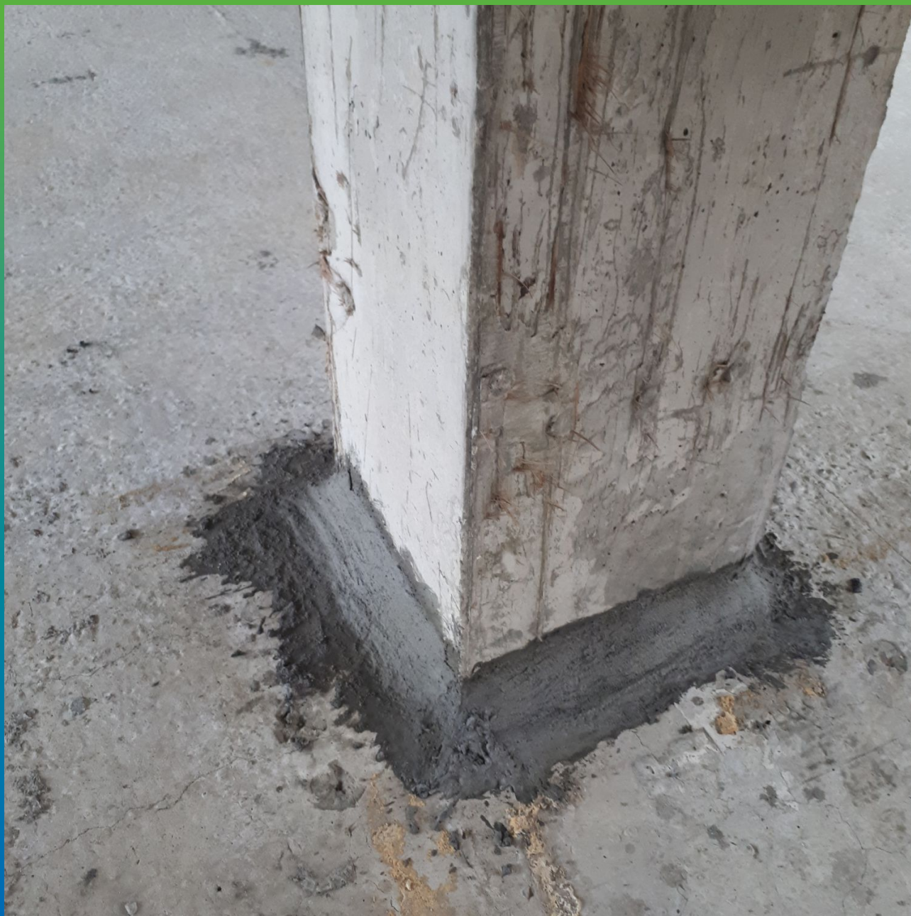
Галтель из Стармекс РМЗ по периметру колонны
