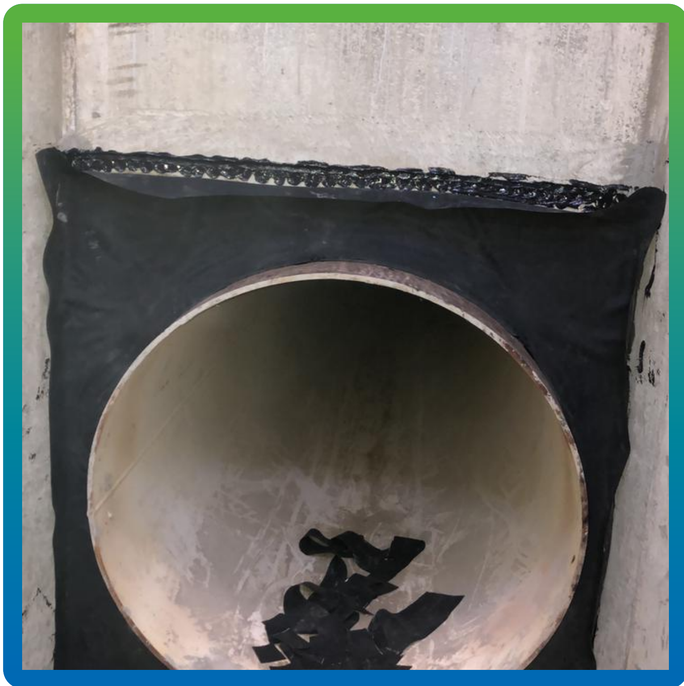
Внешний вид гидроизолированного ввода коммуникации
