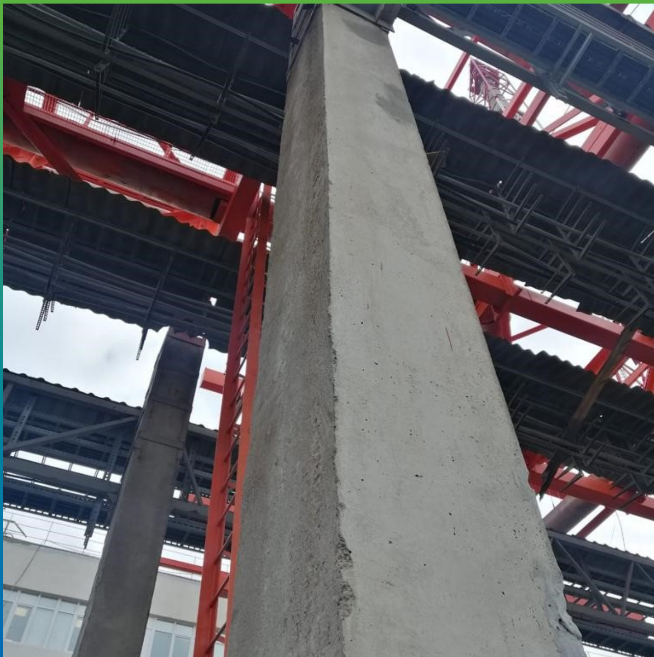
Внешний вид колонн, требующих ремонта
