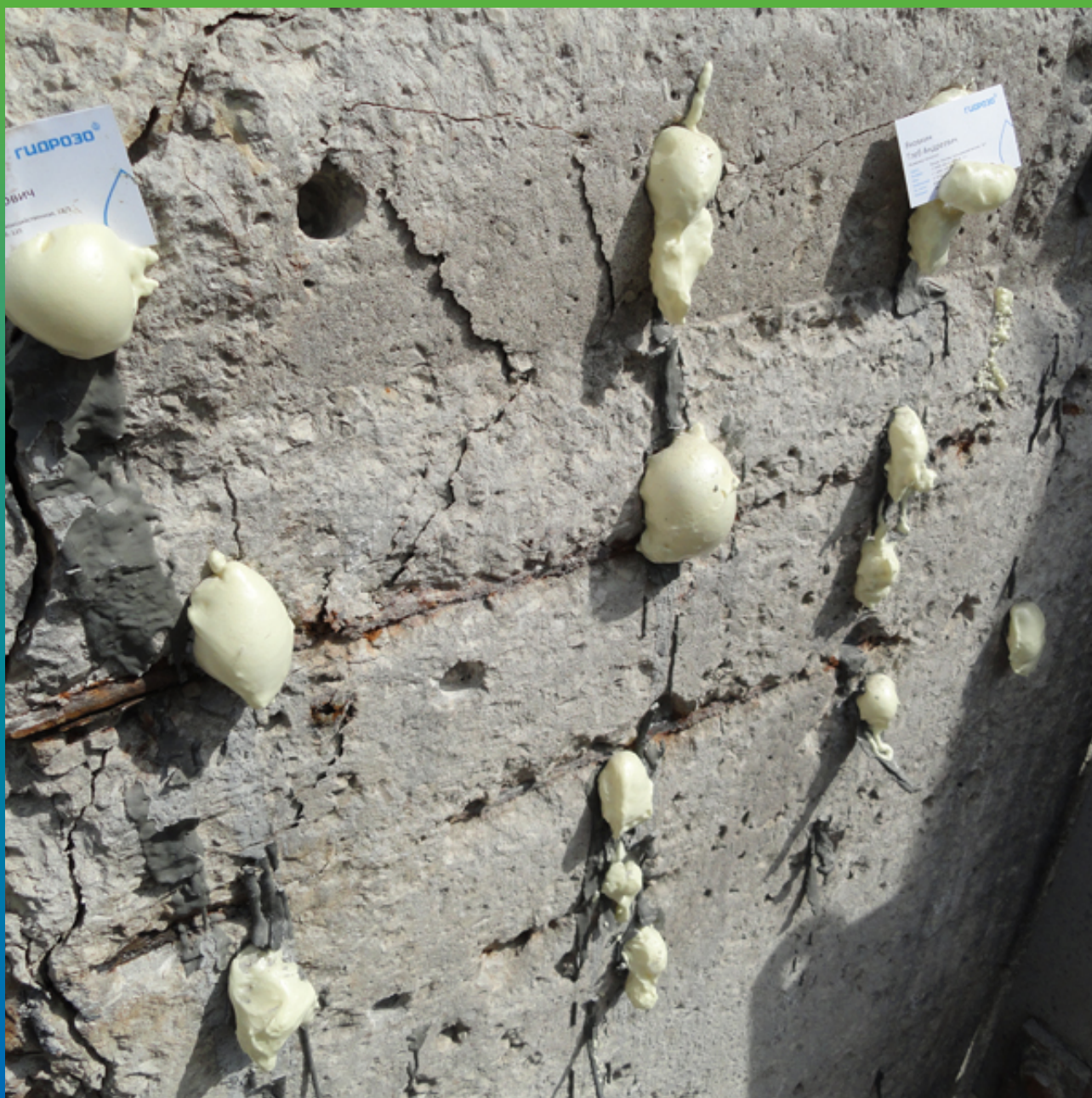
Трещинообразование по сетке шпуров через двенадцать часов
