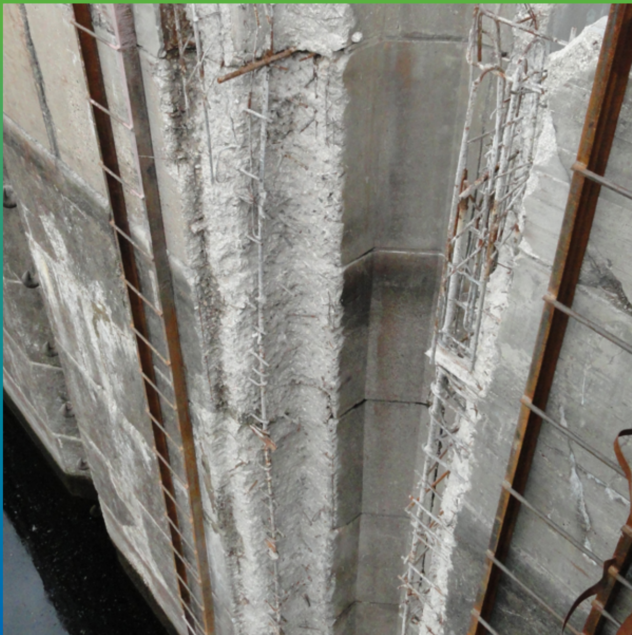
Общий вид разрушенного участка
