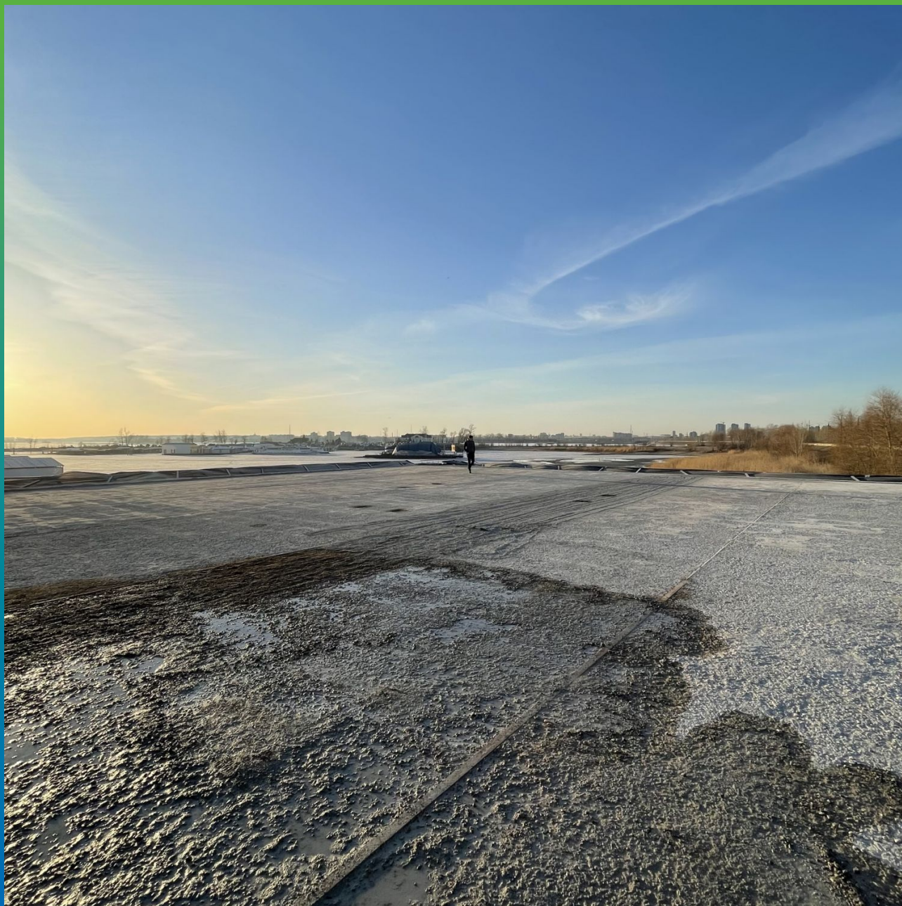
Дефекты основания после удаления рыхлой части бетона
