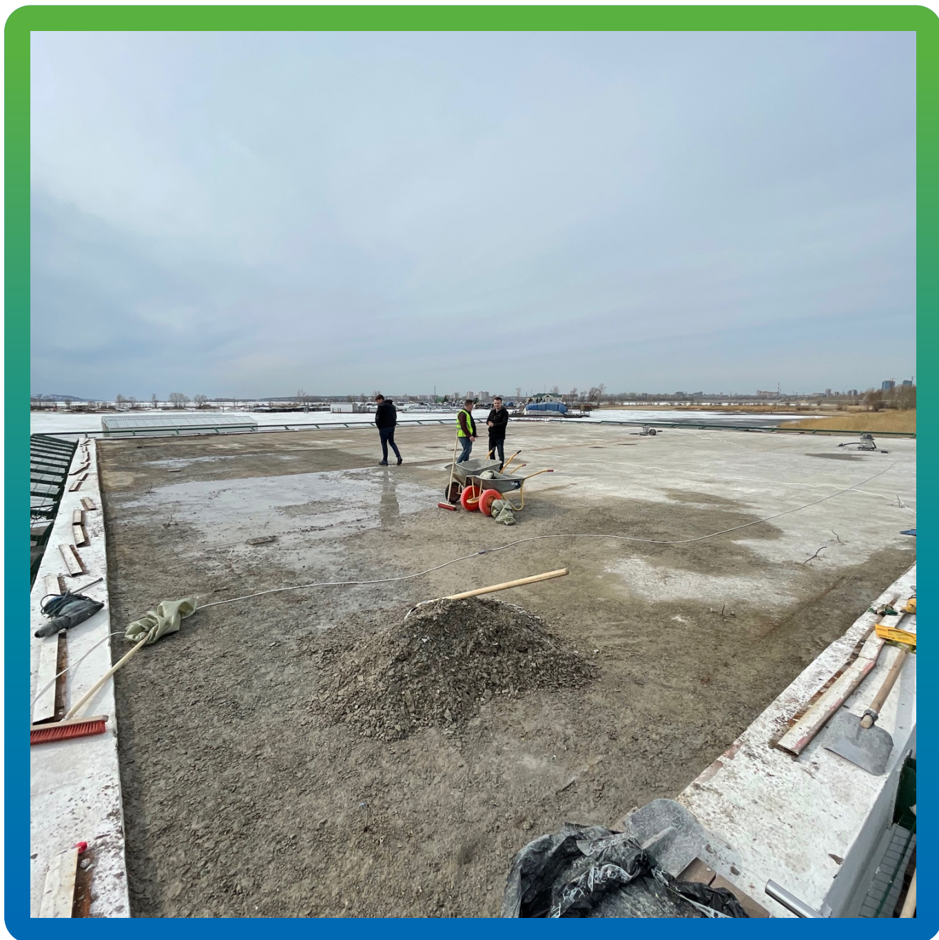
Общий вид разрушения плиты основания
