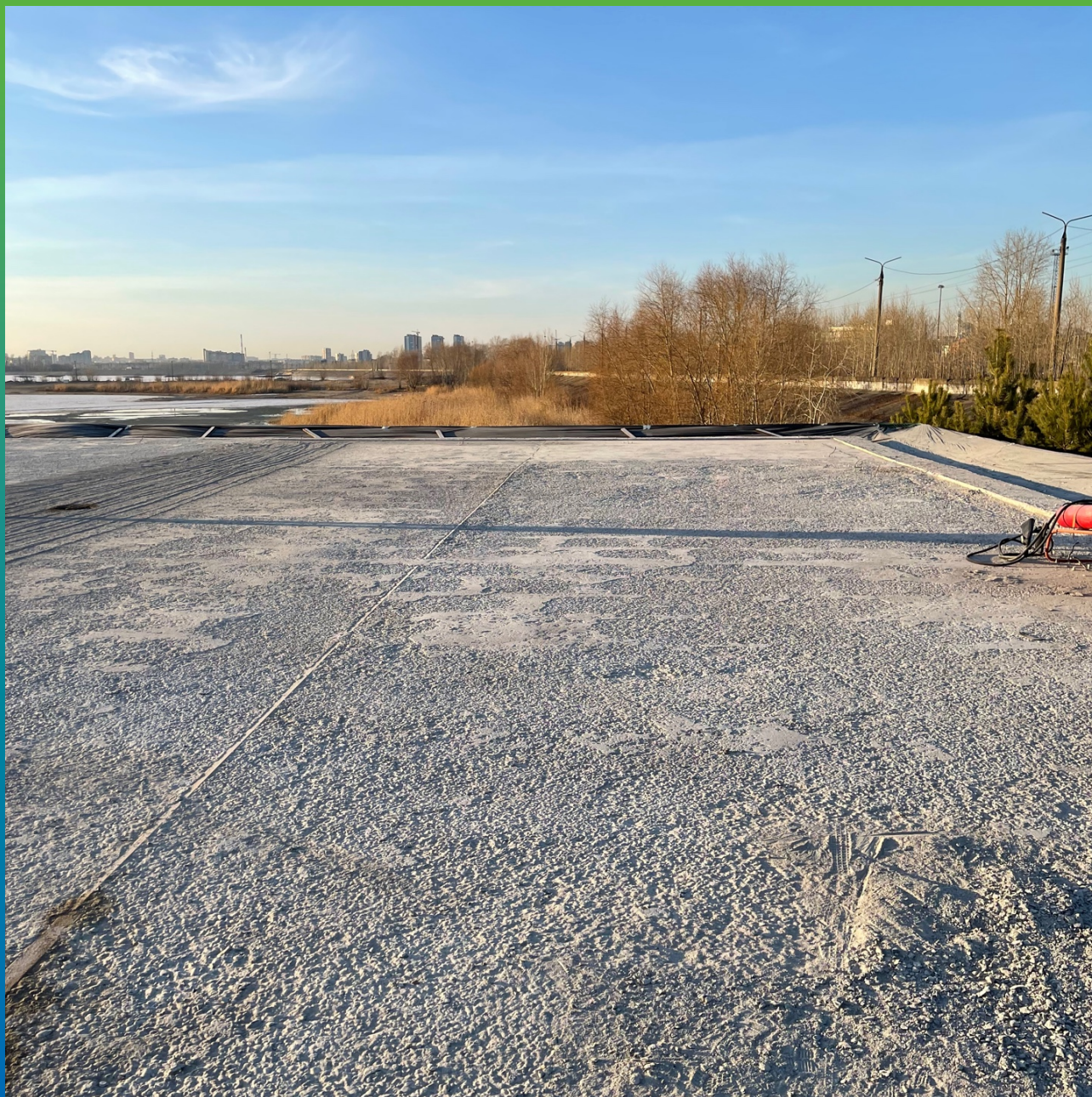
Дефекты основания после удаления рыхлой части бетона
