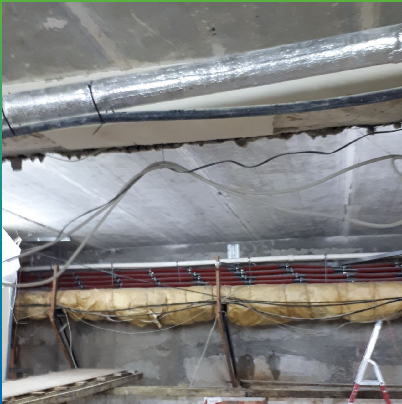
Пустотные плиты перекрытия, требующие усиления
