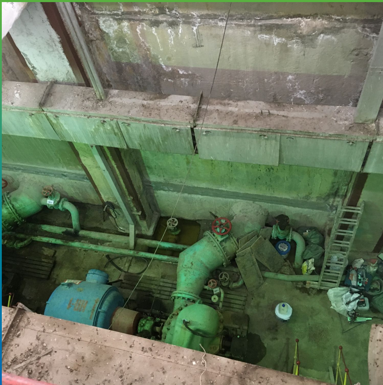
Общий вид станции
