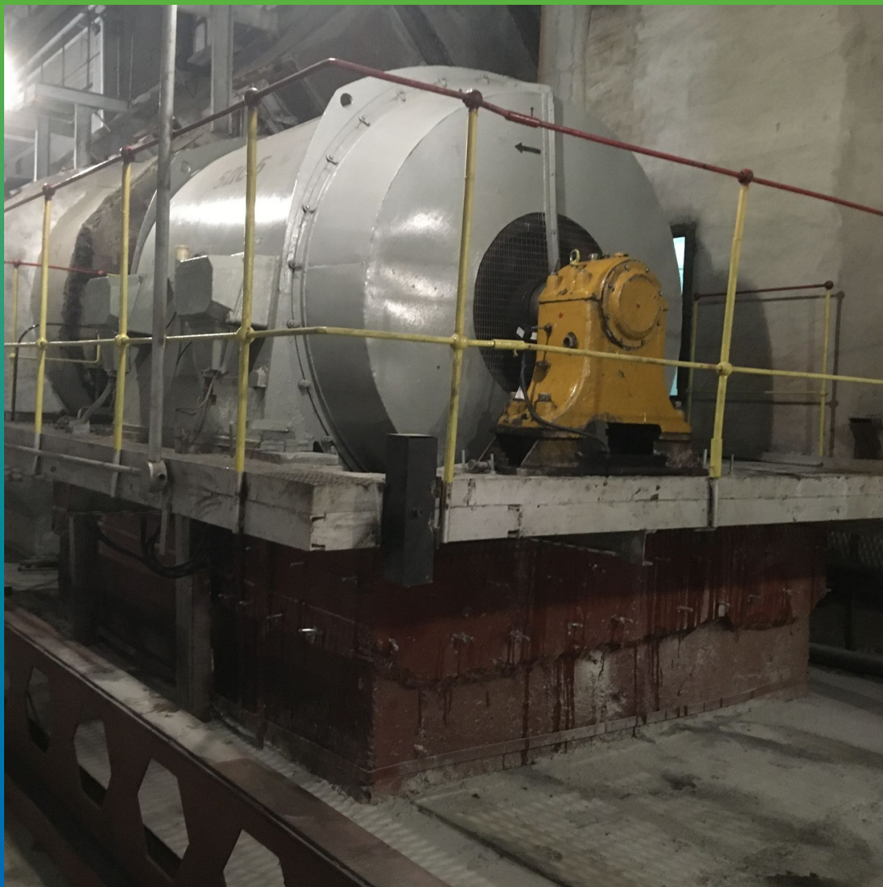
Фундамент подлежащий ремонту. Задача - устранение вибрации.
