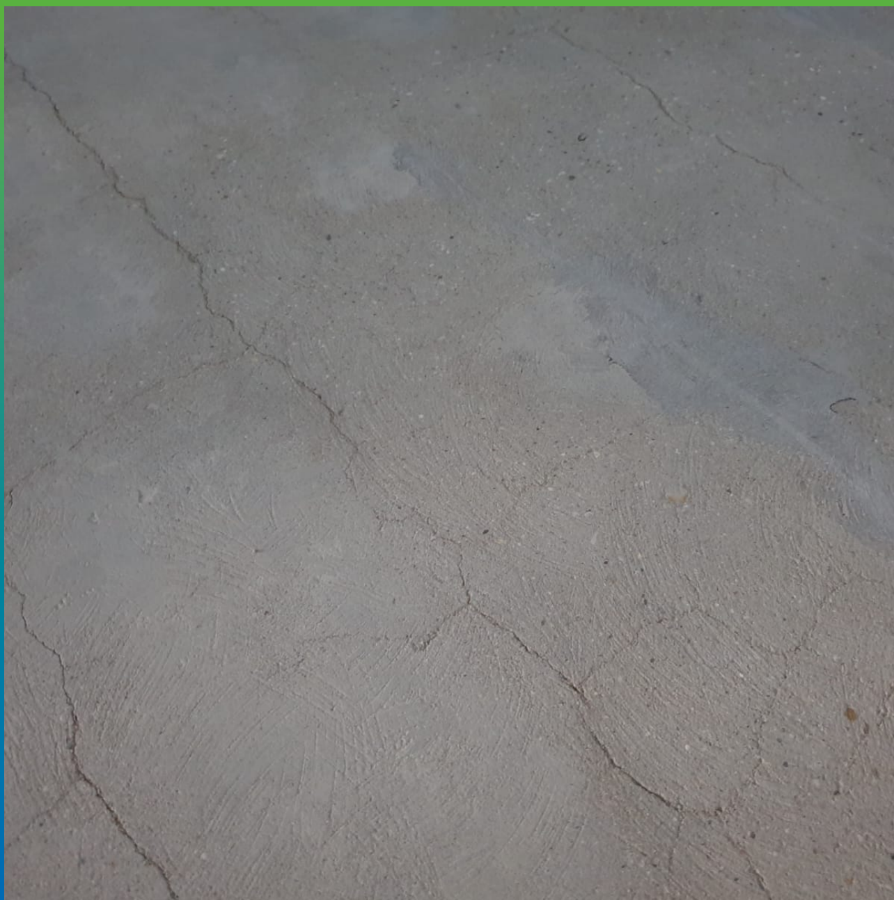
Дефекты выявленные после шлифования поверхности
